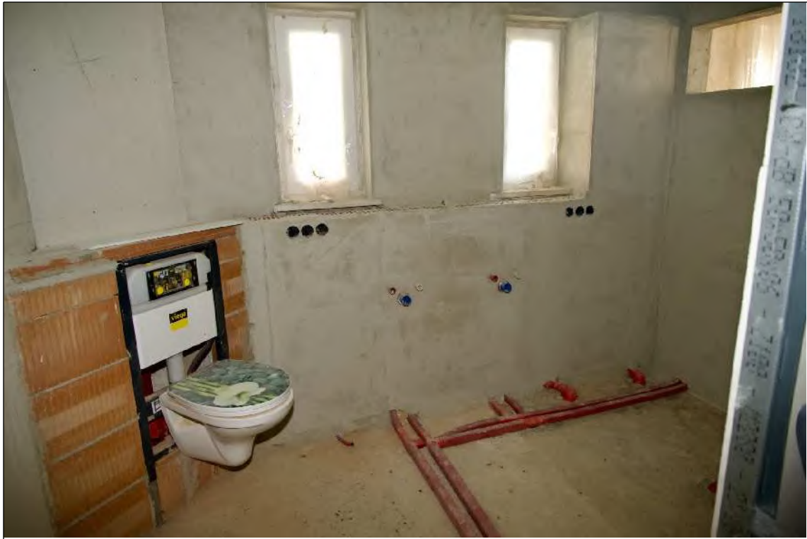
Foto 5 Erdgeschoss - Bad (Installationen sind teilweise vorhanden)
