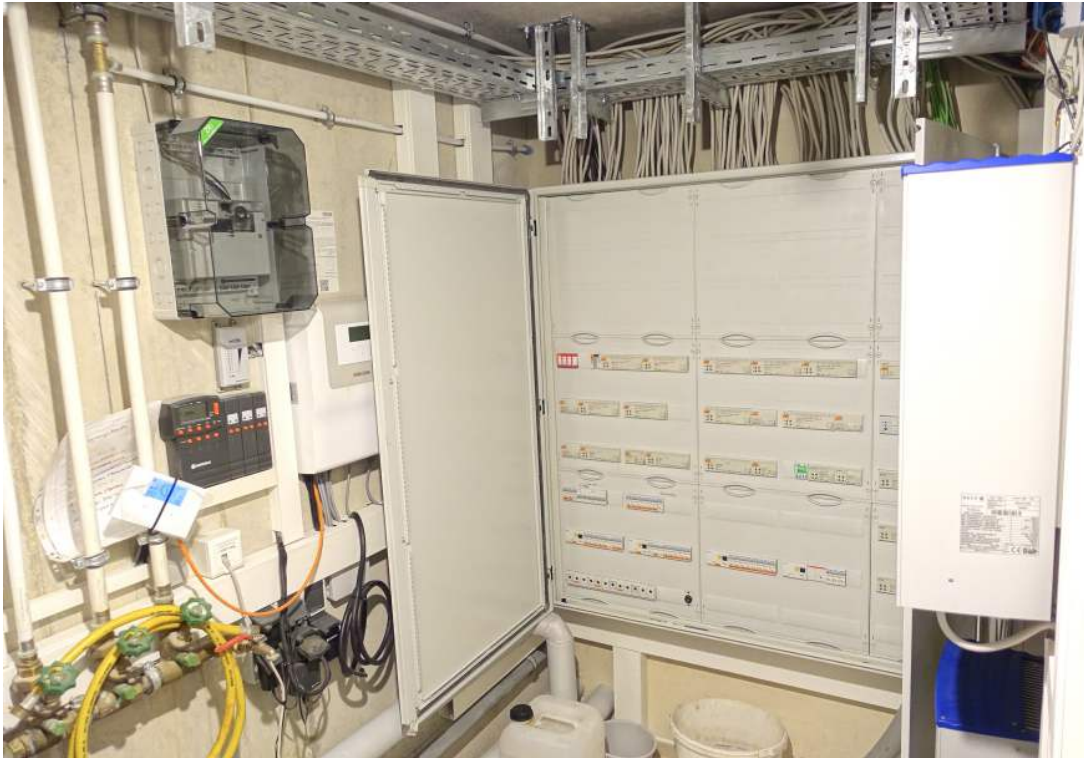
Hausanschluss- und Technikraum
