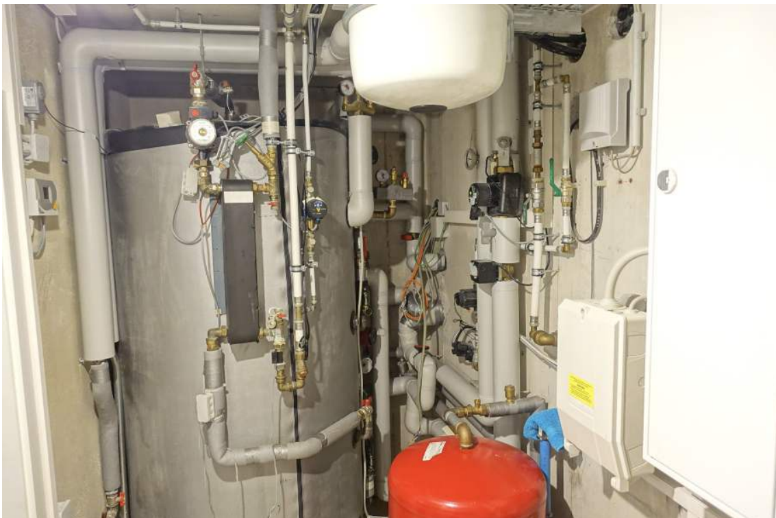
Hausanschluss- und Technikraum
