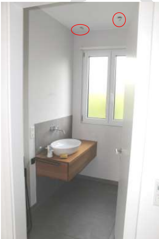
Abb. 14: EG – Duschbad/WC, fehlende Deckenbeleuchtung
