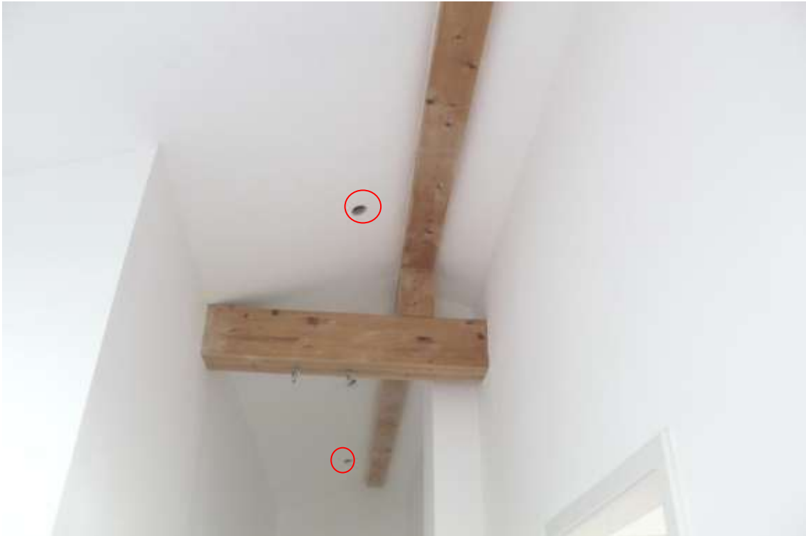
Abb. 16a: Fleckige Dachbalken, fehlende Beleuchtung, beispielhaft
