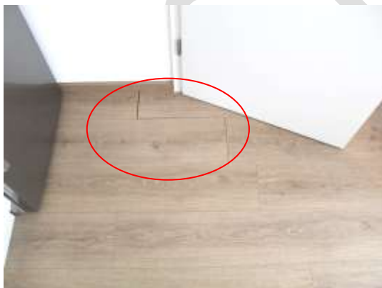
Abb. 28b: Lücken/große Fugen im Boden (beispielhaft)
