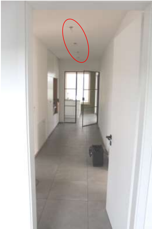
Abb. 8: Flur EG mit Einbauschränk - Blick zur Küche, fehlende Deckenbeleuchtung
