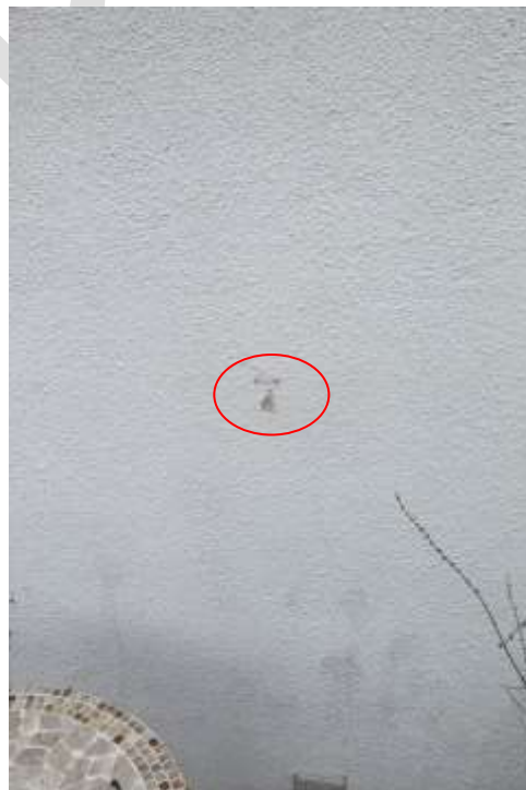
Abb. 39: Putzschaden an Südfassade
