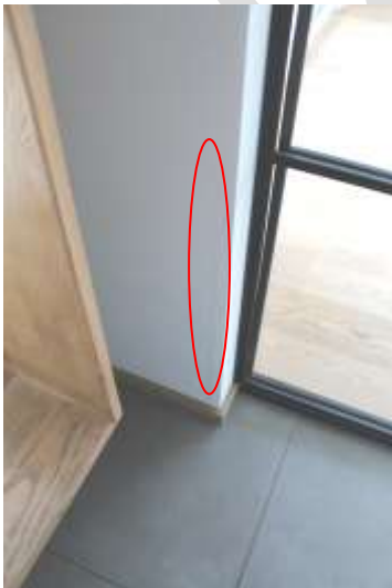
Abb. 12c: Küche, Risse in der Wand (beispielhaft)
