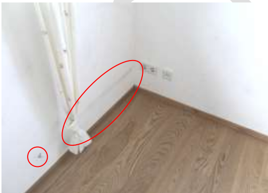
Abb. 17c: Wandbeschädigung durch Markisenanbringung, Gebrauchsspuren, beispielhaft
