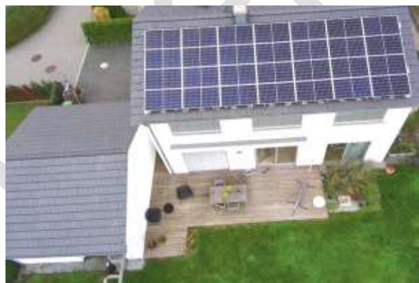
Abb. 44: Photovoltaikanlage – Foto zur Verfügung gestellt von der Antragstellerin. Das Foto wurde nicht am Ortstermin erstellt; es dient zur Darstellung der Module auf dem Dach des Wohnhauses
