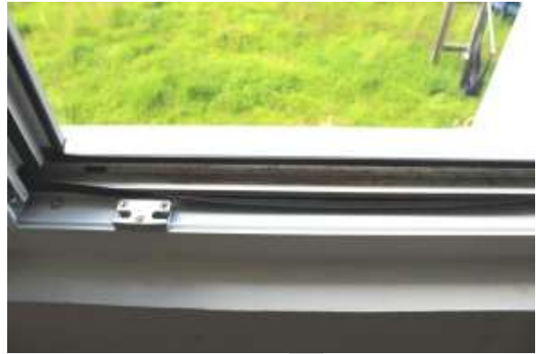
Abb. 17d: Lose Fensterdichtung, beispielhaft
