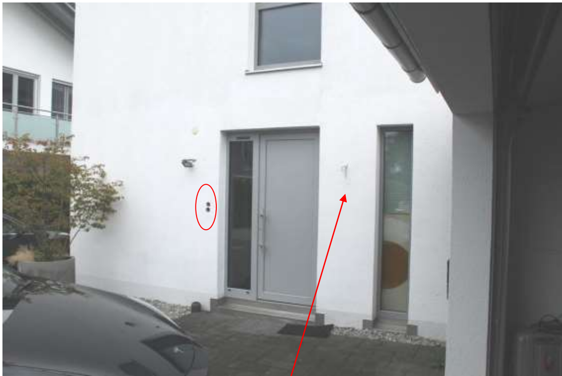
Abb. 6: Haustür, fehlende Schalter und Beleuchtung
