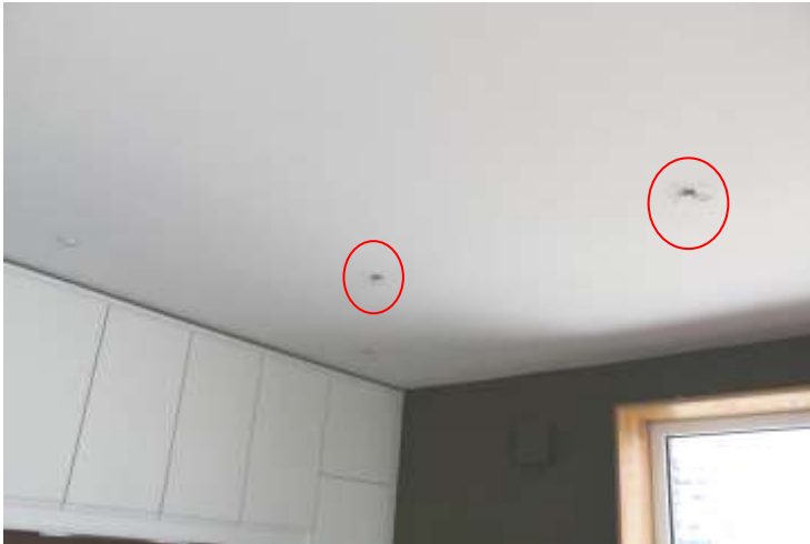
Abb. 12a: Decke Küche – fehlende Deckenbeleuchtung (beispielhaft)
