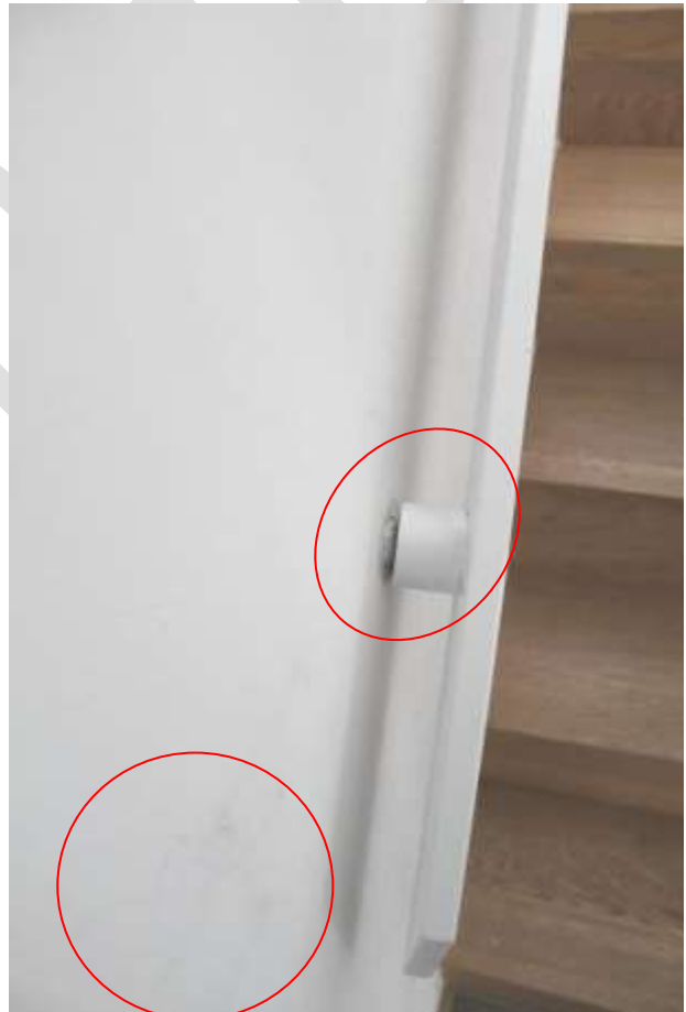
Abb. 15: Treppe ins DG, lockerer Handlauf, Wand Gebrauchsspuren
