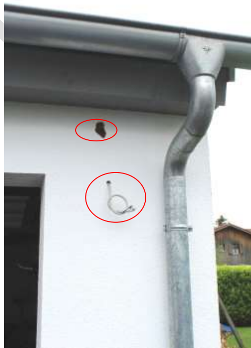
Abb. 34e: Doppelgarage, Beschädigung in Nordfassade, fehlende Beleuchtung
