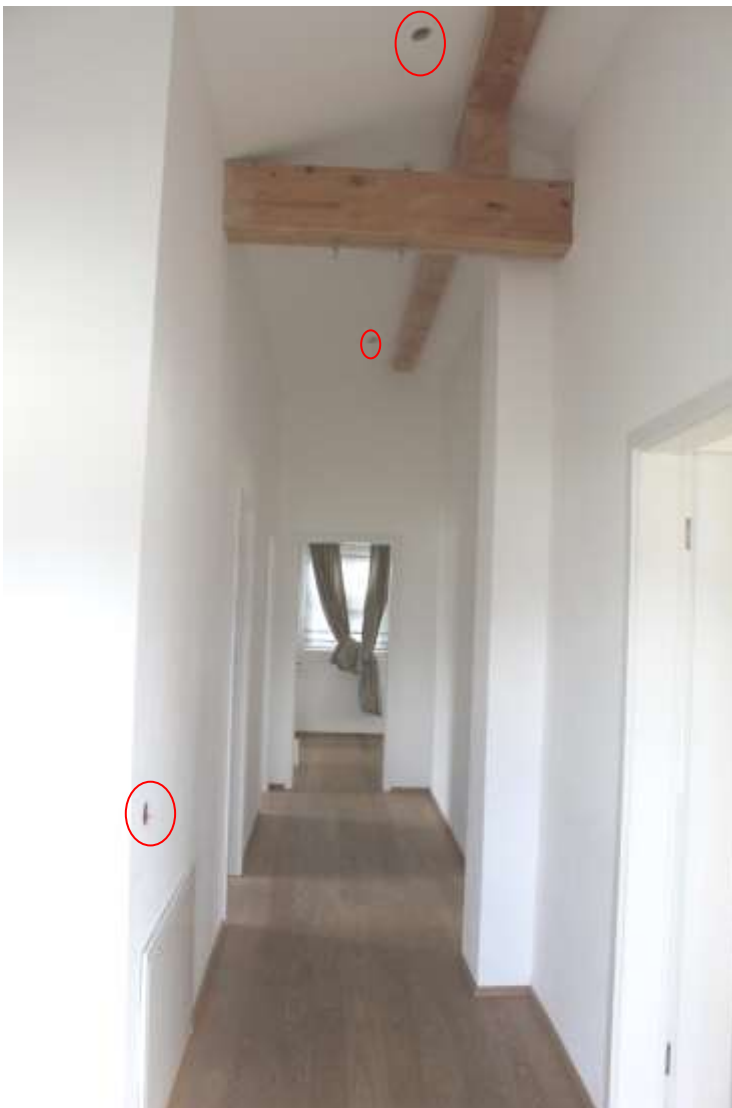
Abb. 16: Flur DG, fehlende Türsprechanlage/Schalter/Lampen
