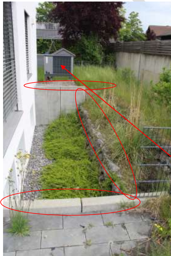
Abb. 4b: Lichtgraben, Stützmauer, fehlende Absturzsicherung, Wärmepumpe
