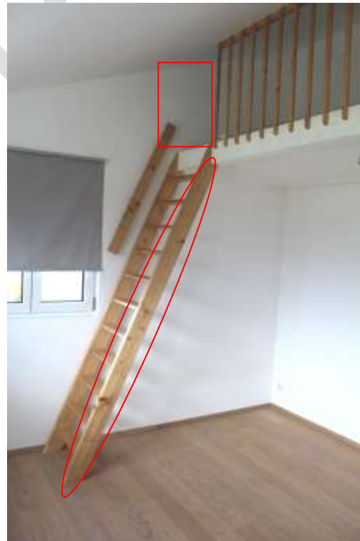
Abb. 17a: Empore, fehlende Absturzsicherung
