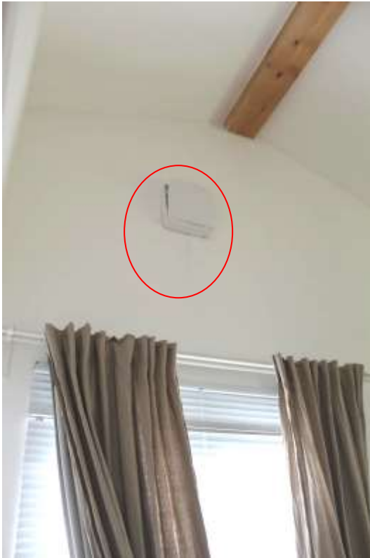
Abb. 19a: Belüftungsanlage Schlafzimmer (beispielhaft)
