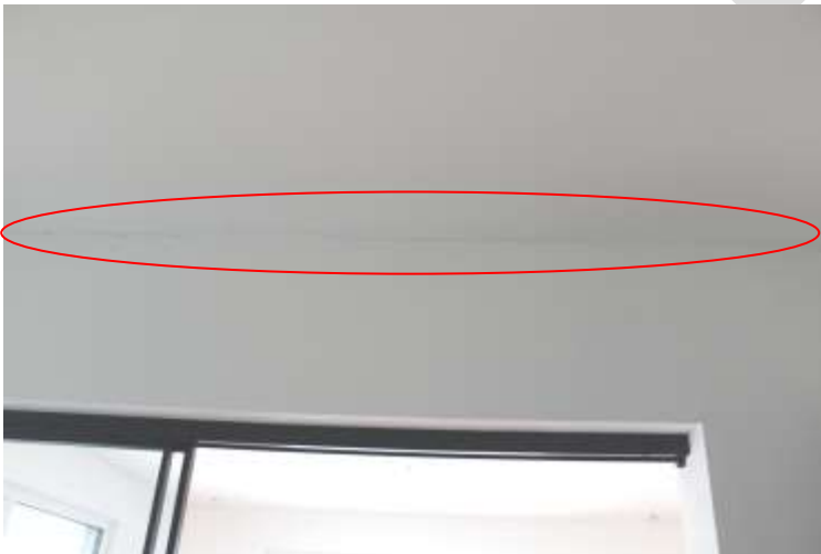
Abb. 12b: Küche, Risse im Wand-/Deckenübergang (beispielhaft)
