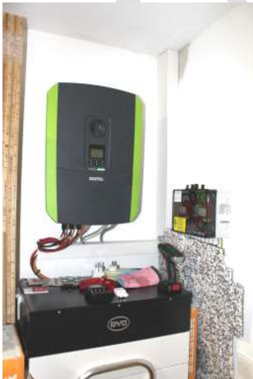
Abb. 26a: Technik Photovoltaikanlage
