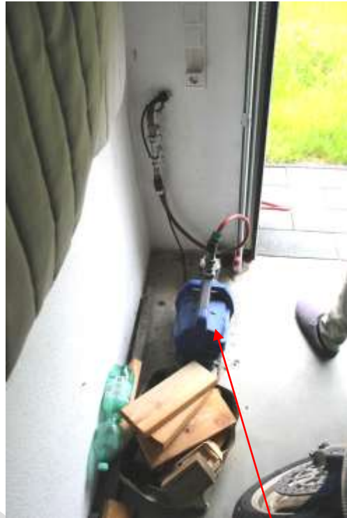
Abb. 34d: Doppelgarage – Wasserpumpe
