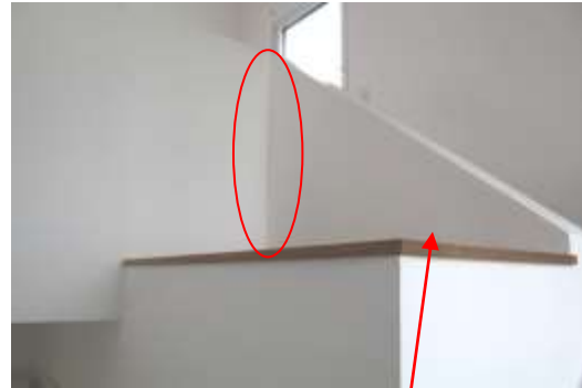
Abb. 15b: Treppe – Ablagefläche, Risse
