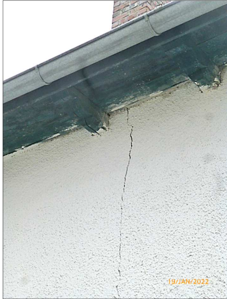
Gebäude C – starker, senkrechter Riss bei Traufe
