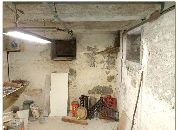
Haus B – feuchter Keller
