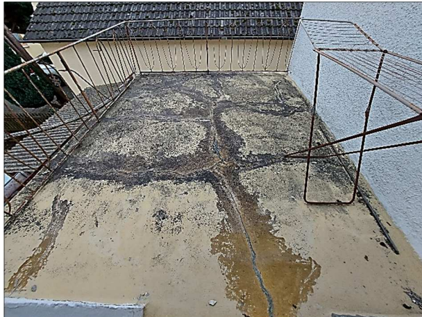
schadhaftes Flachdach neben Haus B, Westseite
