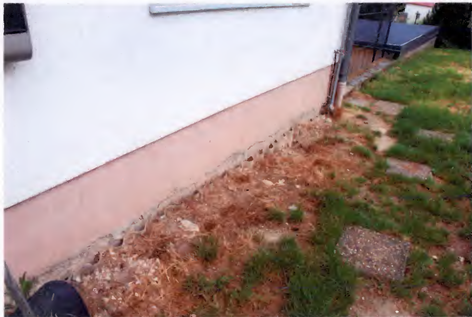
Fehlstelle am südlichen Sockelputz
