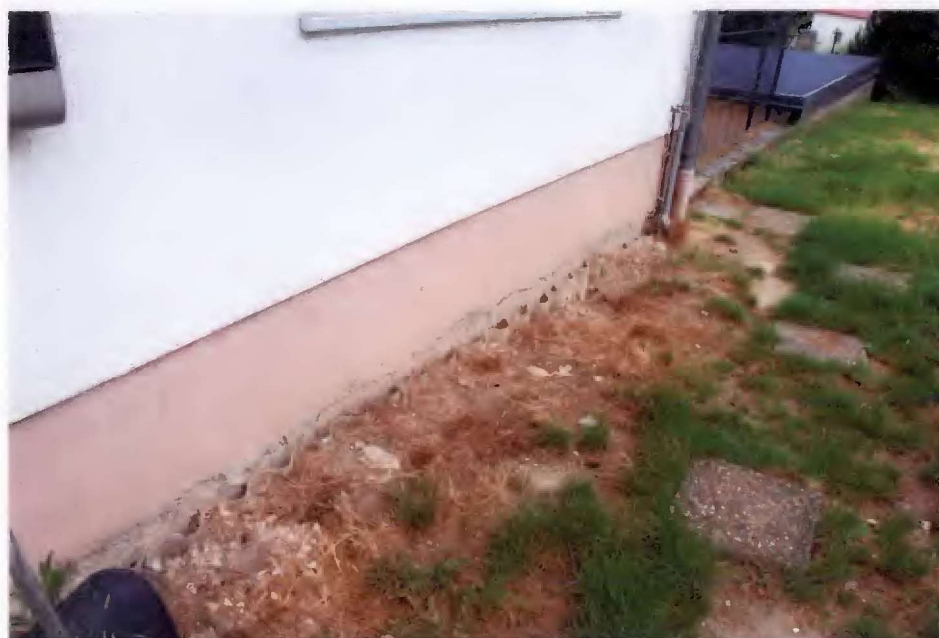
Fehlstelle am südlichen Sockelputz
