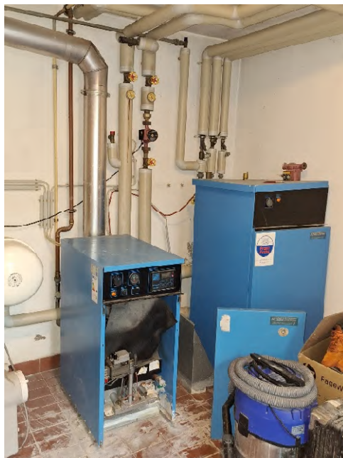
Heizraum im UG
