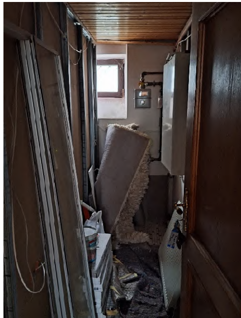
Hausanschlussraum im UG
