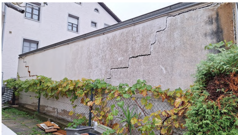
Blick von Nordwesten auf das Nebengebäude (siehe auch Rissbildungen)
