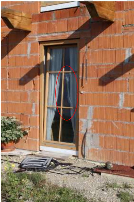
Abb. 12: EG Terrassentürscheibe defekt
