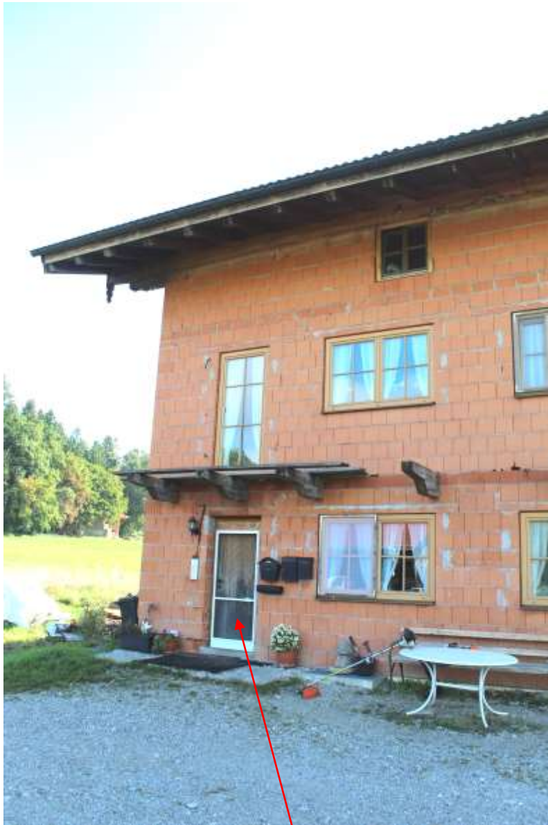
Abb. 13: Westansicht – Haustüre verwitterte Holzteile - beispielhaft
