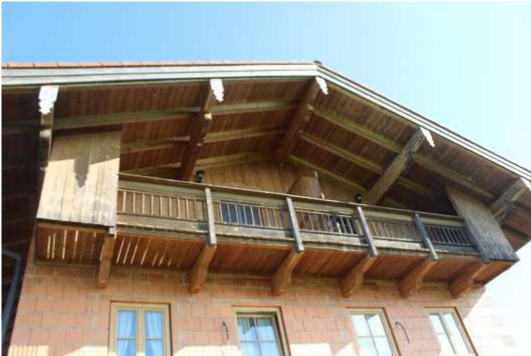
Abb. 11: verwitterte Holzteile (beispielhaft), Lücken im Balkonboden
