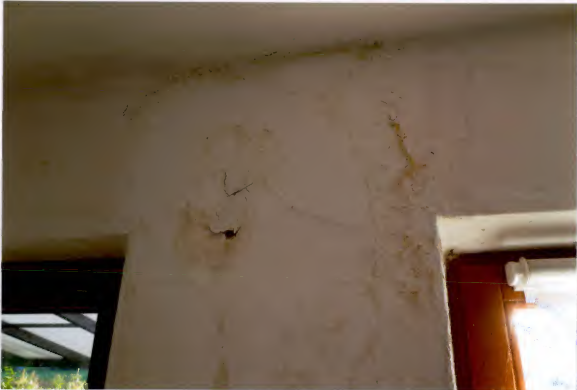
Schaden im Wohnzimmer
