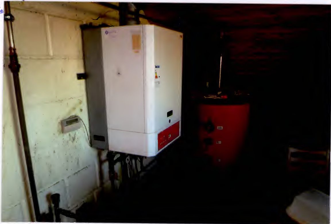
Zentralheizung im Dachgeschoss
