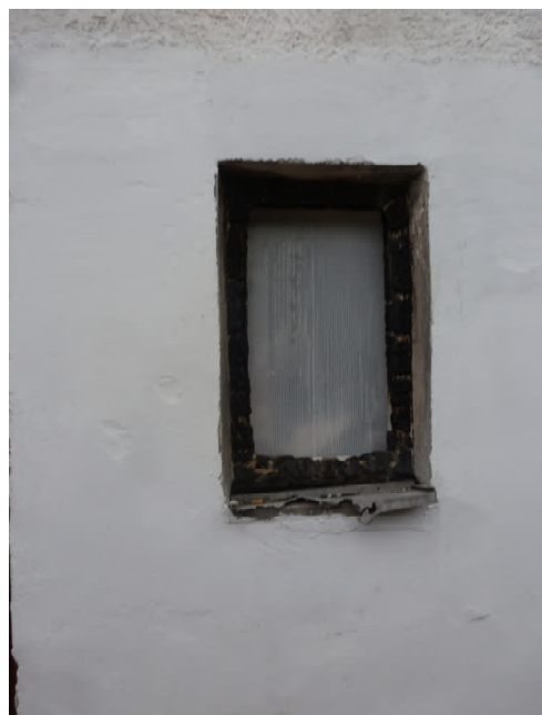
Brandschaden Badfenster im EG
