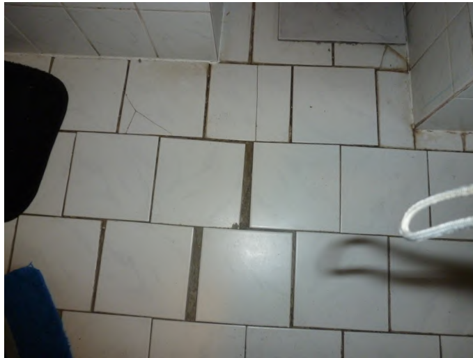
Loser Fliesenbelag beim Bad im OG
