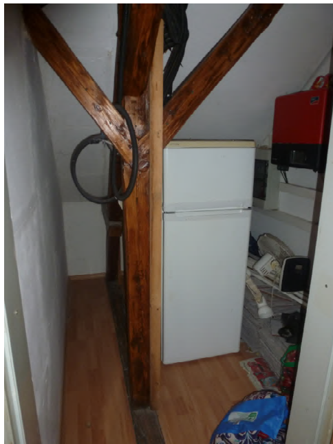
Abstellraum im DG mit Technik der Photovoltaikanlage
