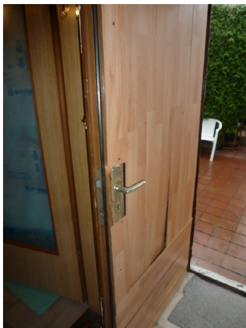
Brandschaden bei der Eingangstür zur Einliegerwohnung
