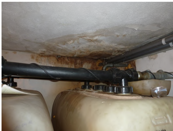
Feuchtigkeitsschäden Deckenuntersicht Heizraum
