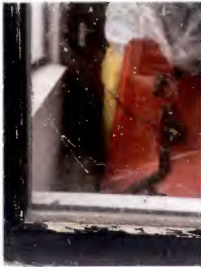
beispielhafte Ansicht der Farbabplatzungen am Holz-Fensterrahmen des Eingangsbereichs
