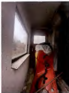
beispielhafte Teilansicht der zum Teil fehlenden Fliesen und der sich ablösenden Paneeldecke im Eingangsbereich
