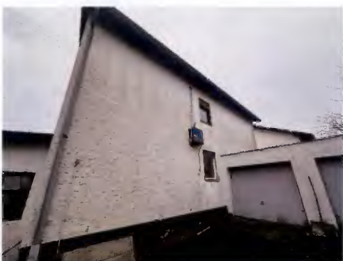
beispielhafte Ansicht der Farbabplatzungen im Sockelbereich der Fassaden-Nordseite
