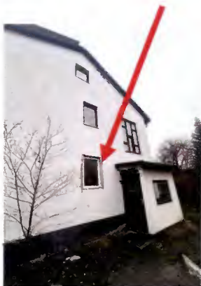
beispielhafte Ansicht des unfachmännisch eingeputzten Fensters im Bad der Erdgeschoss-Wohnung
