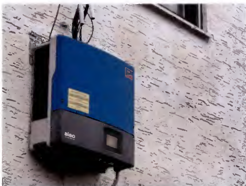
beispielhafte Ansicht der unfachmännisch verlegten Kabel zum Wechselrichter an der Gebäude-Nordseite
