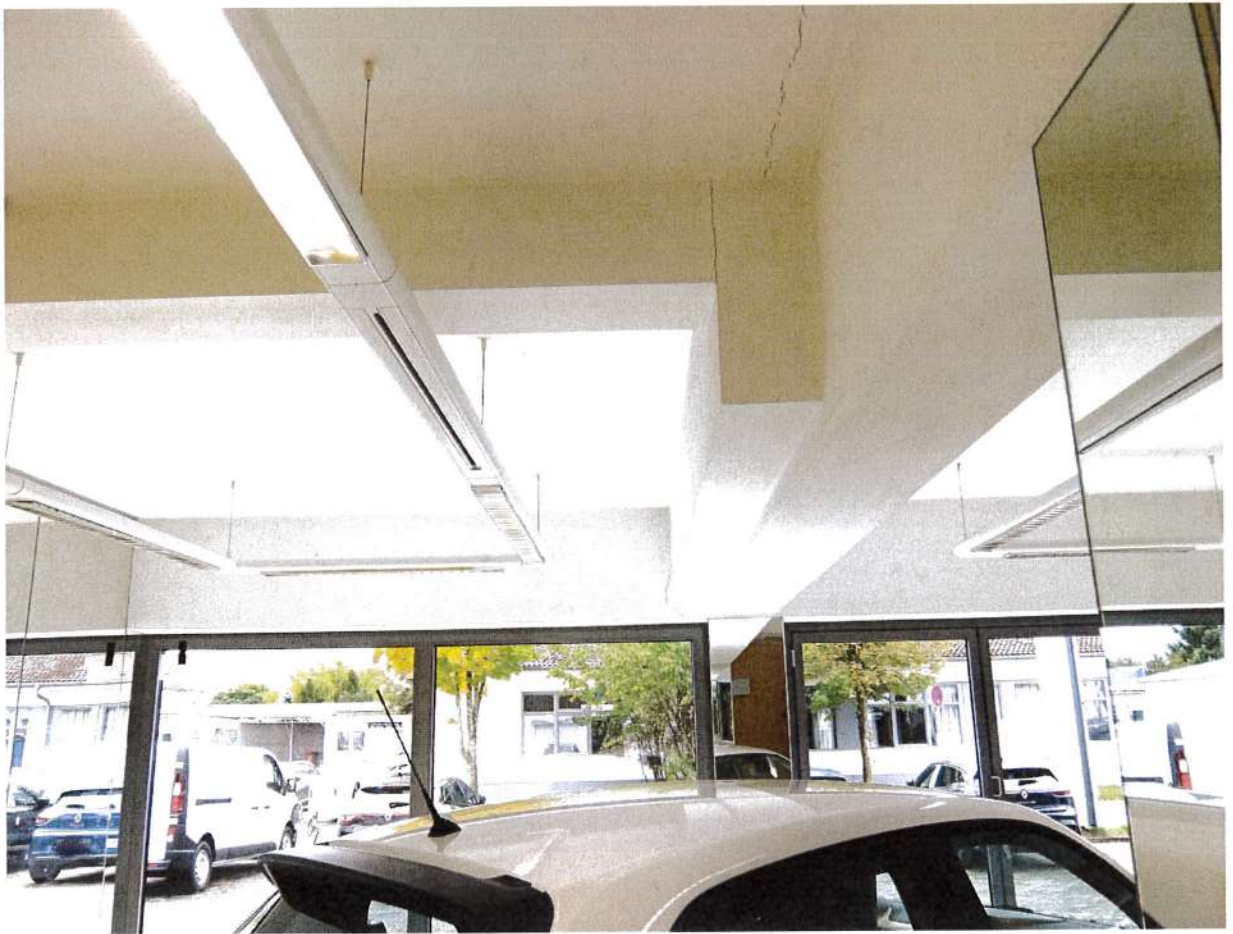
Abbildung (24) Ausstellungshalle: Deckenrißbildung
