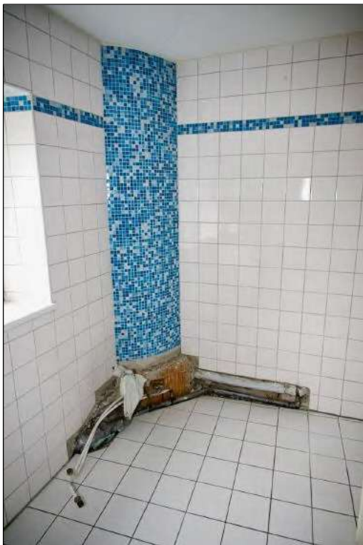
Foto 10 Obergeschoss - Bad, Anschluss für Badewanne
