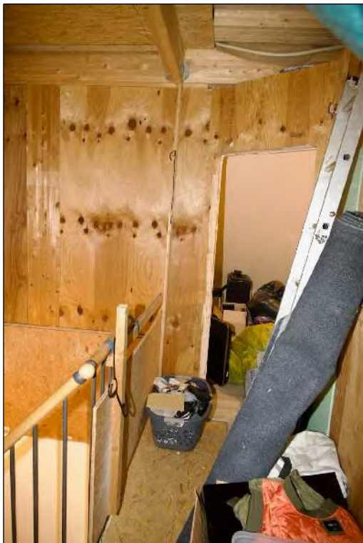
Foto 15 Sondereigentum 1 - Dachgeschoss, Treppenhaus (nicht fertiggestellt)
