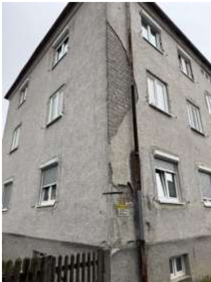
Detail Fassade (Putzschäden)
