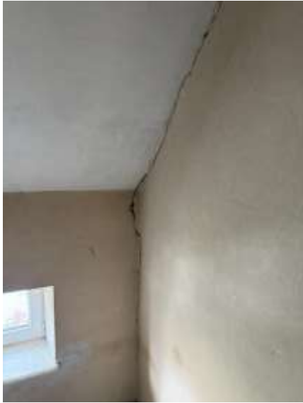
Detail Rissbildung Treppenhaus
