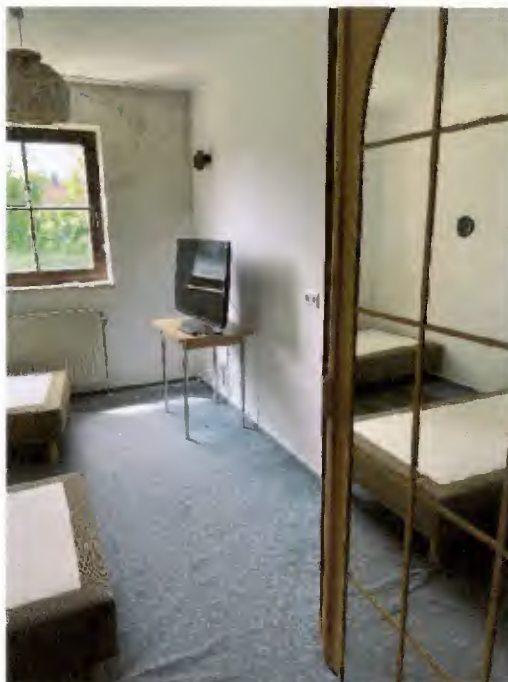
Zimmer im OG mit Schimmel an der Außenwand
