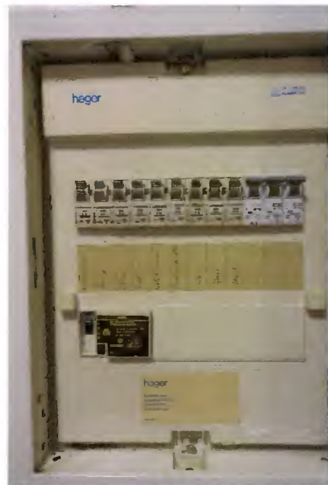
Sicherungskasten in der Betreiberwohnung
