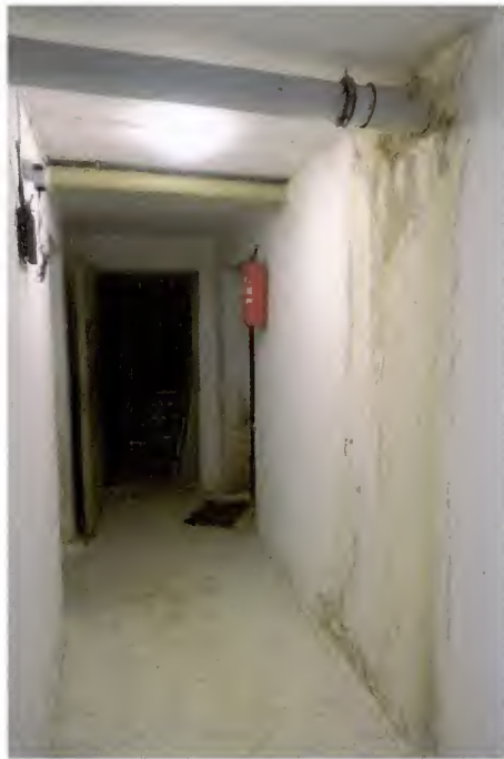
Wasserschaden im Kellergang
