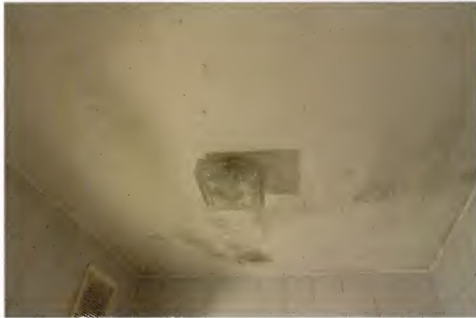
Schimmel an der Badezimmerdecke
