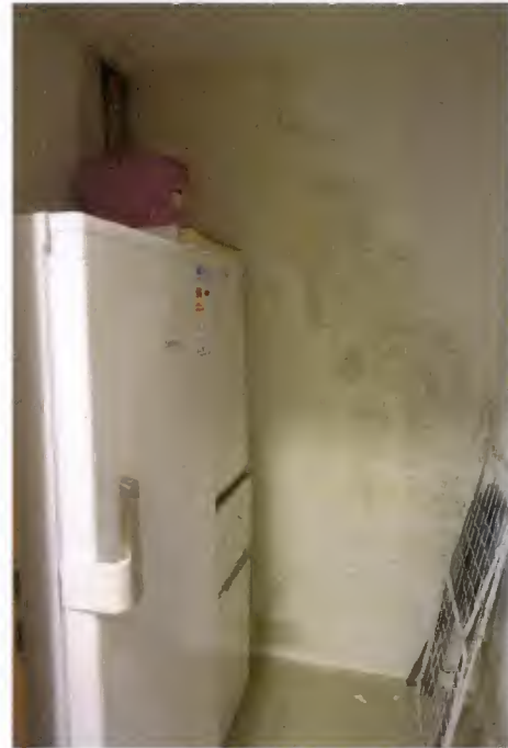
Abstellraum mit Wasserschaden
