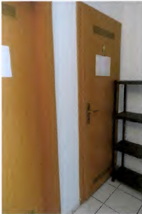
WC-Anlagen im EG (defekt)
