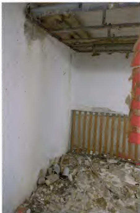
Schäden durch defekte Rohrleitung
