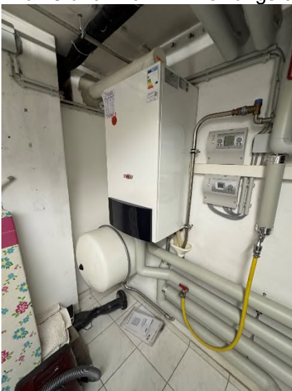
Bild 13 und Bild 14 – Heizungsraum
