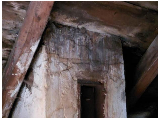
stark versotteter Kamin
