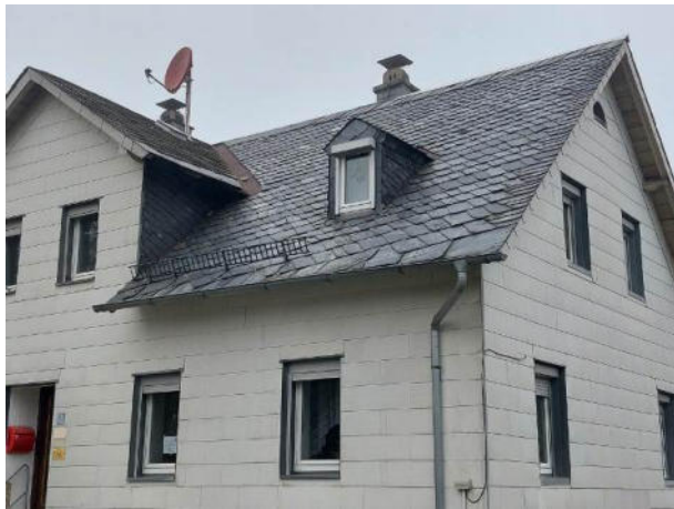
deutlich gealterte Dacheindeckung
