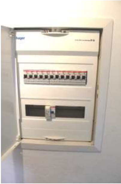
Abb. 26: Sicherungskasten in der Wohnung
