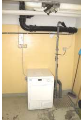
Abb. 28a: Wäschekeller, gemeinsch. Trockner, Pumpensumpf
