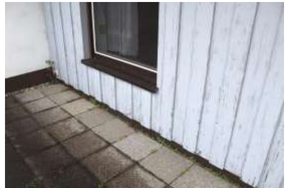
Abb. 20d: Dachterrasse – Holzverschalung anstrichbedürftig
