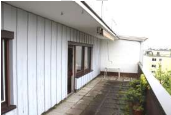
Abb. 20a: Dachterrasse, Teilüberdachung, Unkrautbewuchs
