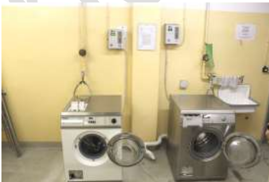
Abb. 28: Wäschekeller - Gemeinsch. Waschmaschinen
