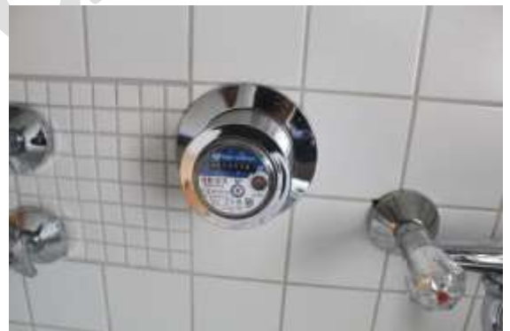
Abb. 24b: Küche - Kaltwasserzähler
