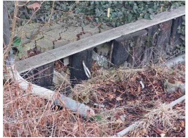
schadhafte Palisaden und Pflasterfläche
