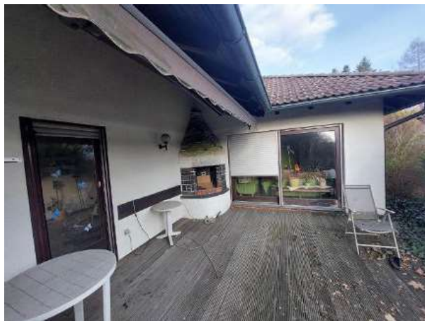
Terrasse mit schadhafter Terrassentür
