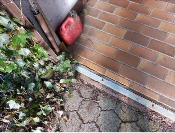
schadhaftes Tor, Fliesen und Pflaster
