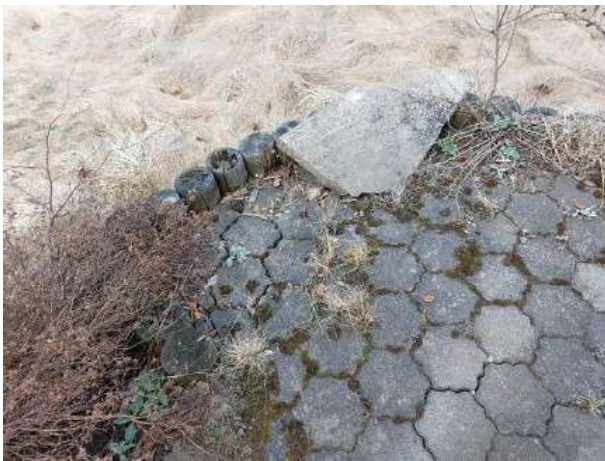
schadhafte Palisaden und Pflasterfläche
