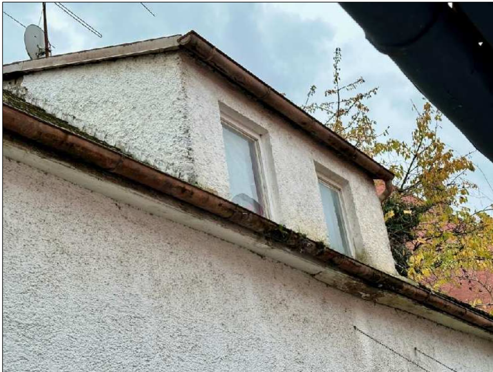
Foto 5 Detail Gaube mit defekter Regenrinne
