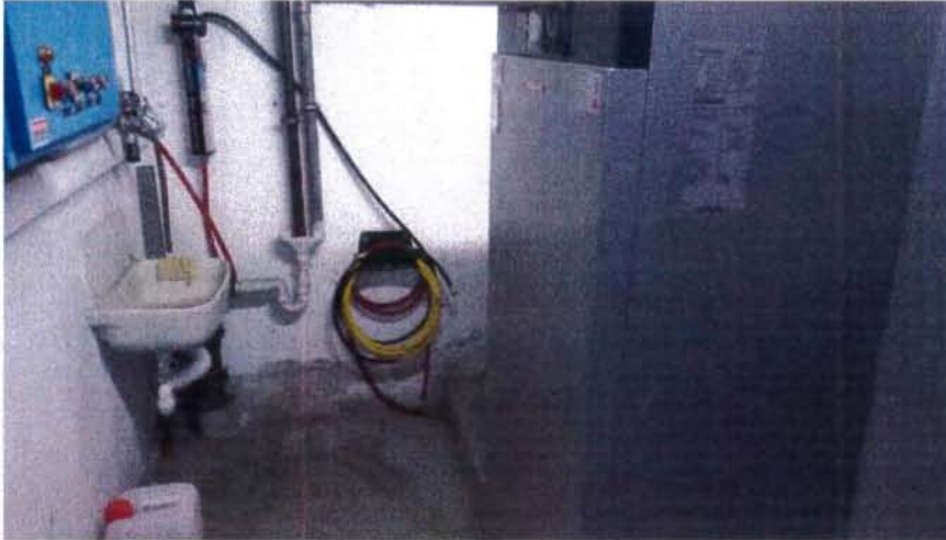
Abbildung Heizungsraum im Haus Graslitzer Straße 9
