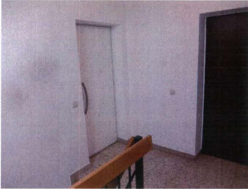
Abbildung(11) Eingangstüre vom Treppenhausflur in den Hobbyraum Nr. 18 im Dachgeschoss des Hauses Graslitzer Straße 9.
