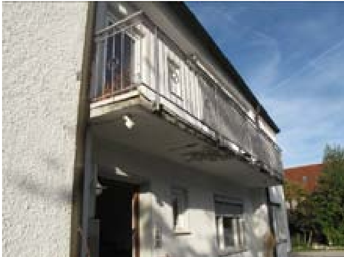
Brach liegender Süd-Balkon über dem Haupt-Eingang
