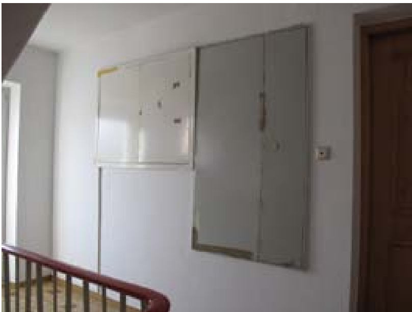
Strom-Verteilerkästen im Treppenhaus / Obergeschoss
