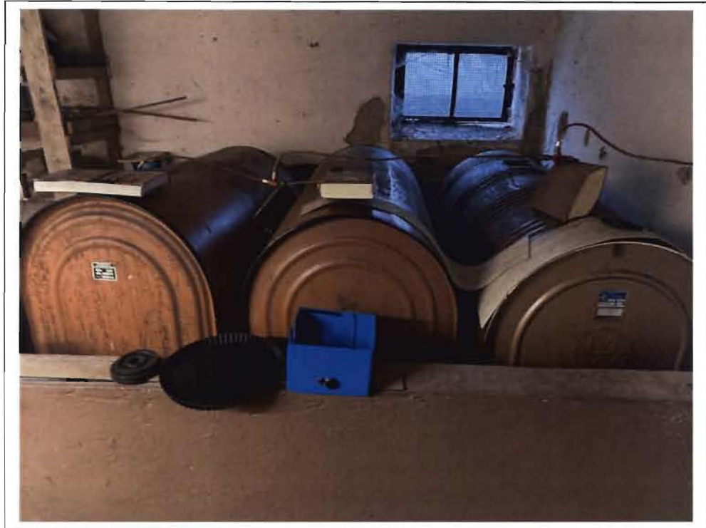
Foto 17: Blick in den Tankraum
