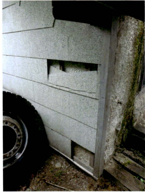
Blick auf die beschädigten Faserzementplatten des Wohnhauses Kolpingstraße 9
