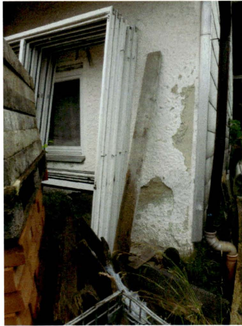
Blick auf die Putzschäden an der Nordfassade des Wohnhauses Kolpingstraße 9
