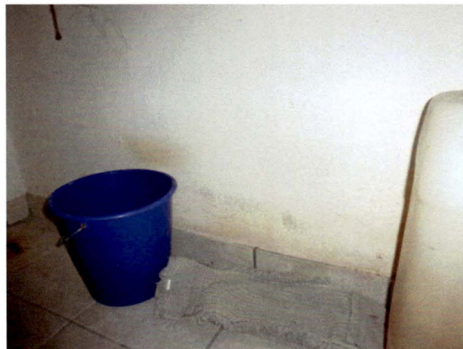
Feuchtigkeitsschäden im Heizungs-/ Waschraum
