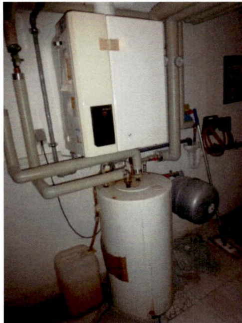
Heizung im KG
