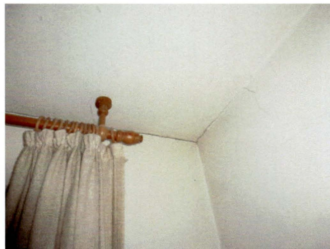
Rissbildungen im Flur im OG
