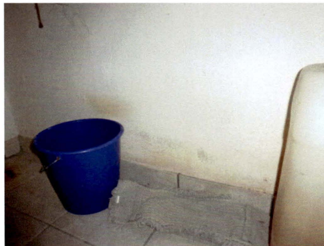
Feuchtigkeitsschäden im Heizungs-/ Waschraum
