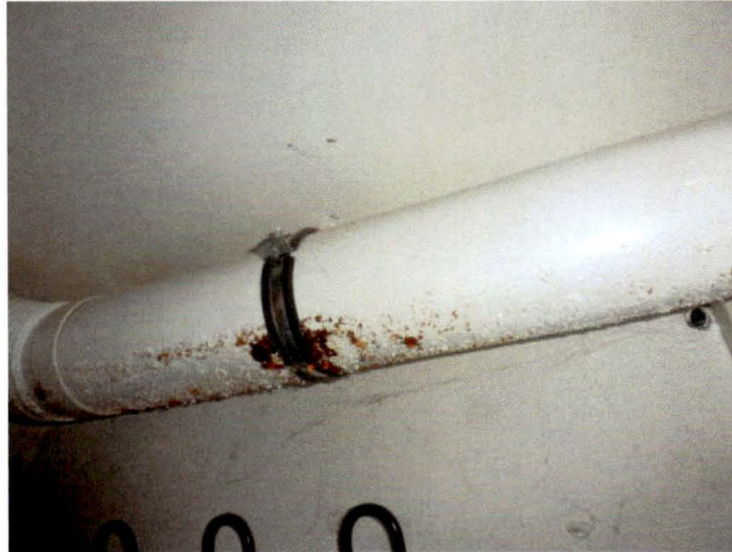
Korrosion Abgasrohr Heizung
