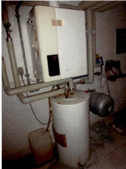
Heizung im KG
