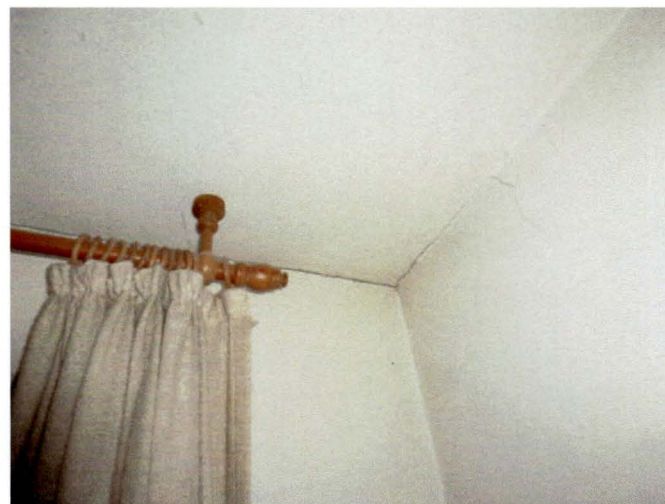
Rissbildungen im Flur im OG
