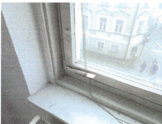
abgewittertes Fenster DG
