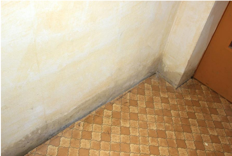
Feuchtflecken im Sockelbereich
