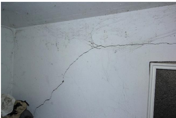
Risse in der Garagenwand
