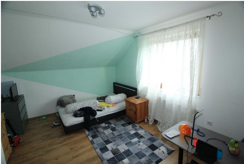
Feuchtflecken im Sockelbereich
