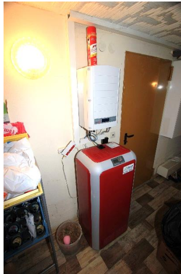
Flur mit Akkuspeicher
