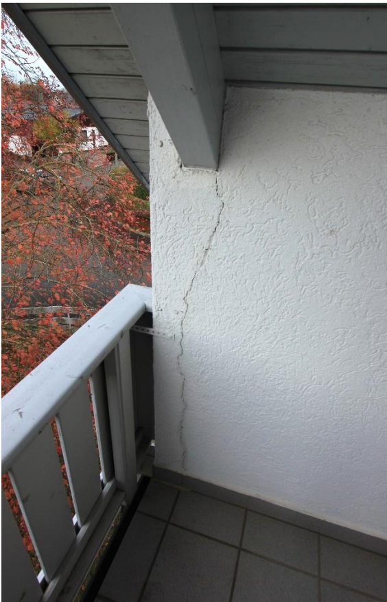
Riss in der Wand
