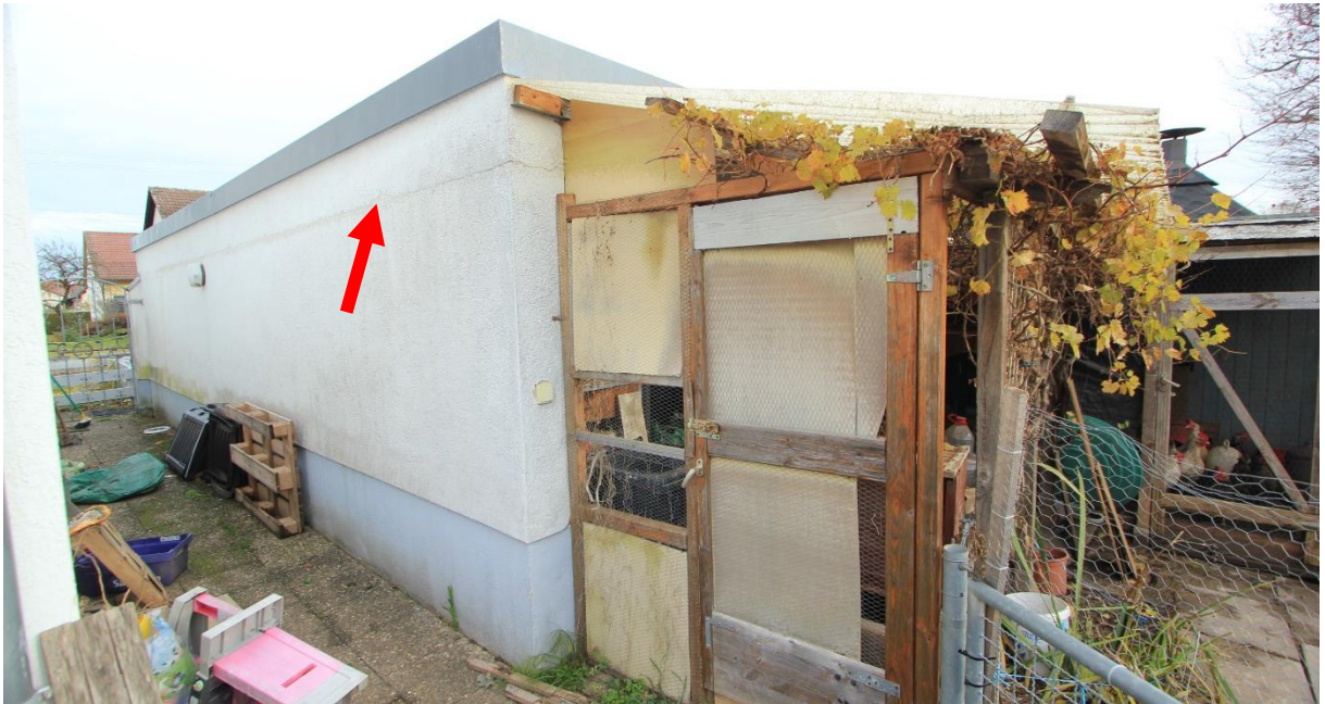
Gang und Garage mit Schuppenanbauten, Pfeil Riss in der Wand
