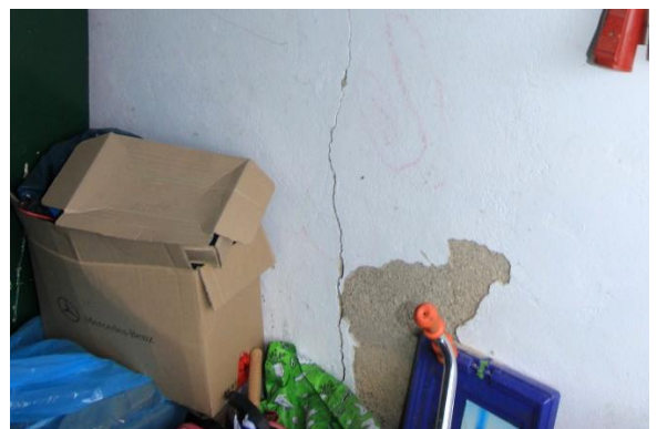
Risse in der Garagenwand
