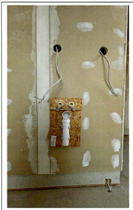
Foto 22: Anschlüsse im Bad
