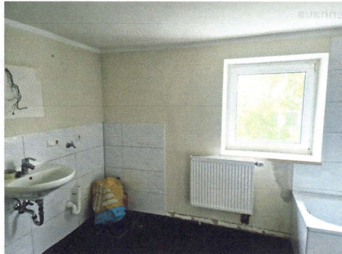
Wohnung OG Bestand (Bad mit verschiedenen Abnutzungsspuren)
