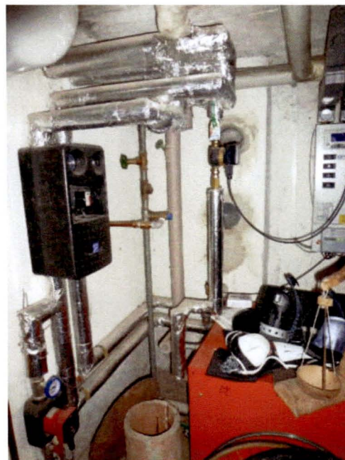
Heizung im KG
