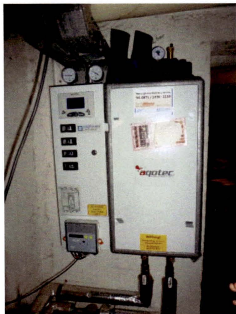
Heizung im KG
