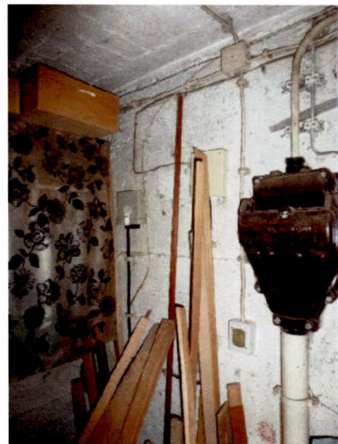
Elektroinstallationen im KG
