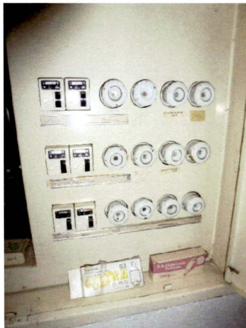
Elektrohauptabsicherung im KG
