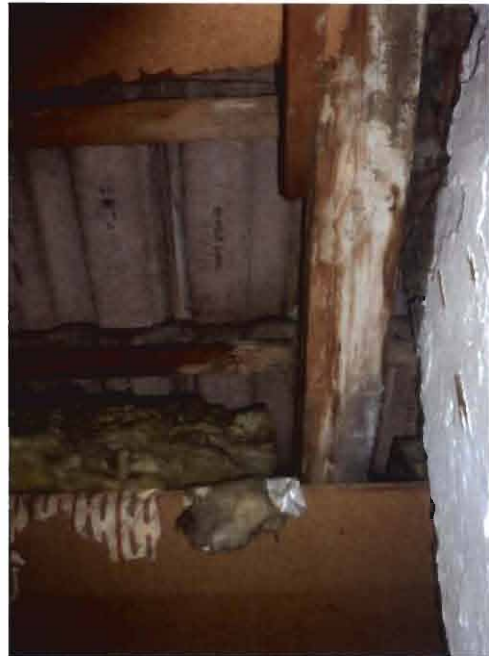
Fehlende Dämmung an den Dachschrägen und Feuchtflecken am Dachstuhl
