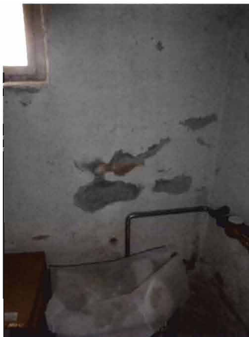
Putzschäden an der KG-Außenwand
