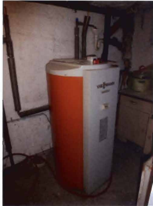
Warmwasserspeicher im KG
