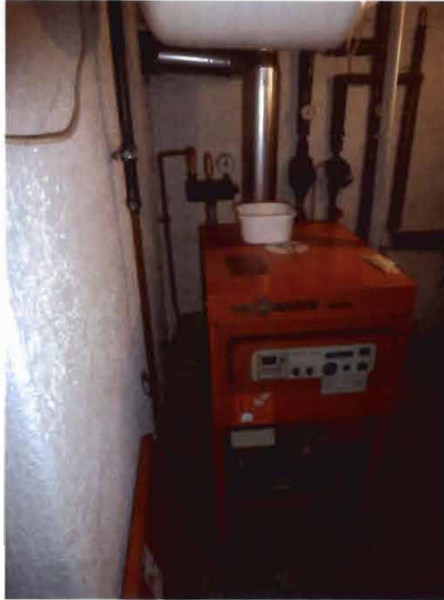
Heizung im KG
