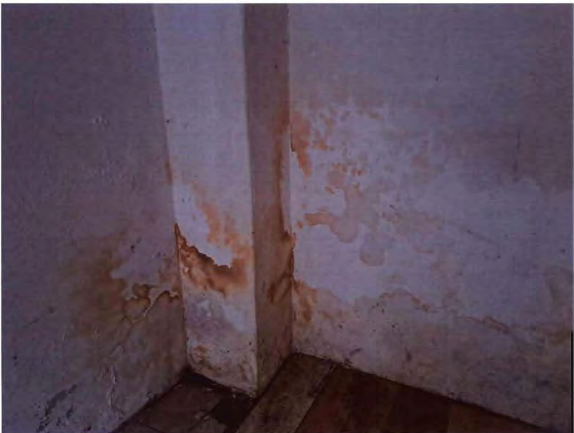
36 Fleckenbildung am Kamin, Hinweis auf mögliche Kaminversottung
