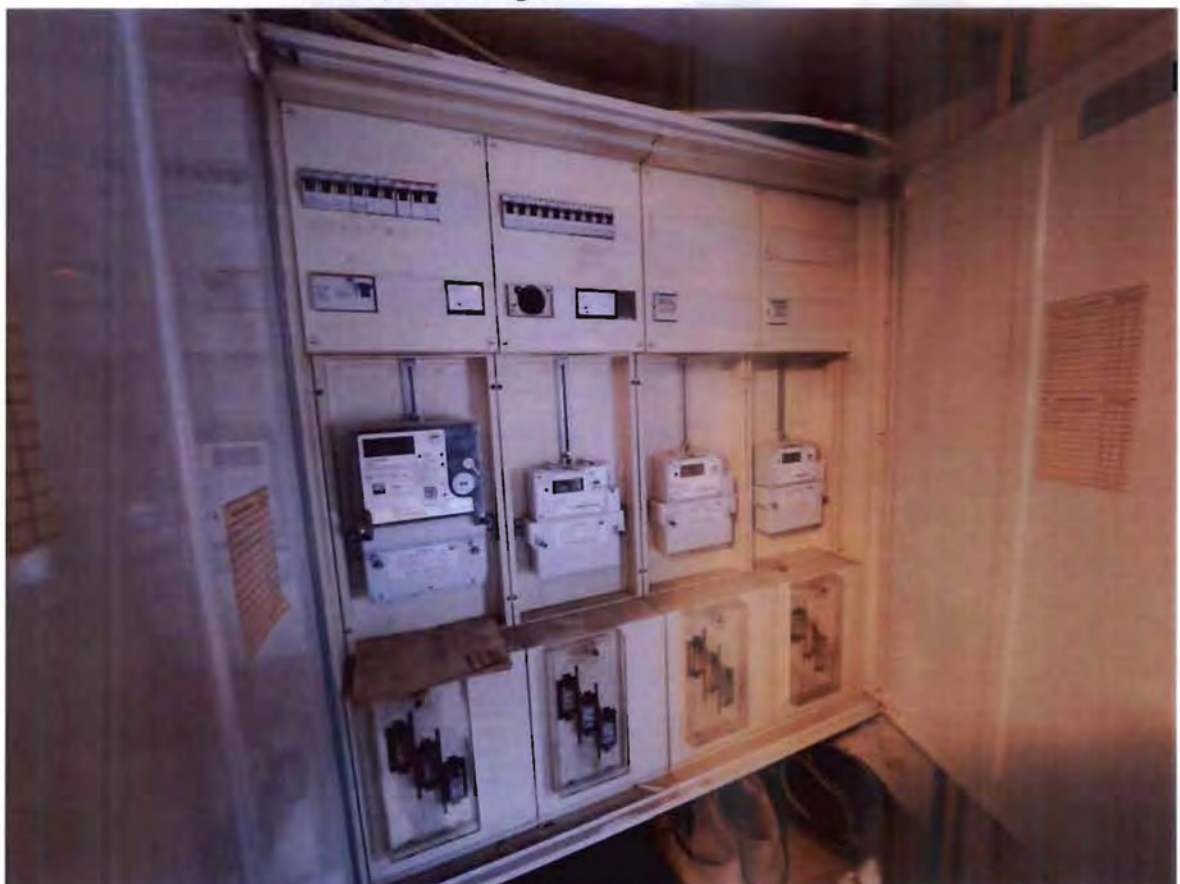
18 Hauptverteilung mit FI-Schutzschalter
