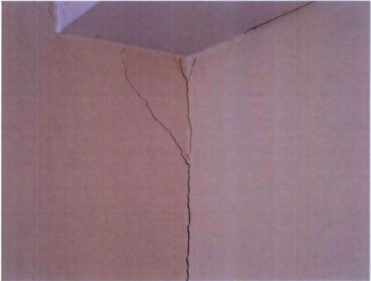
37 Rissbildung an der Raumecke Schlafzimmer, Wohnung Nr. 1 OG
