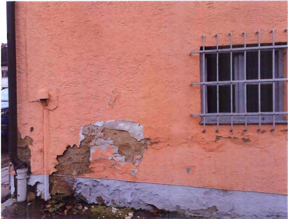
33 großflächiger Schaden am Außenputz
