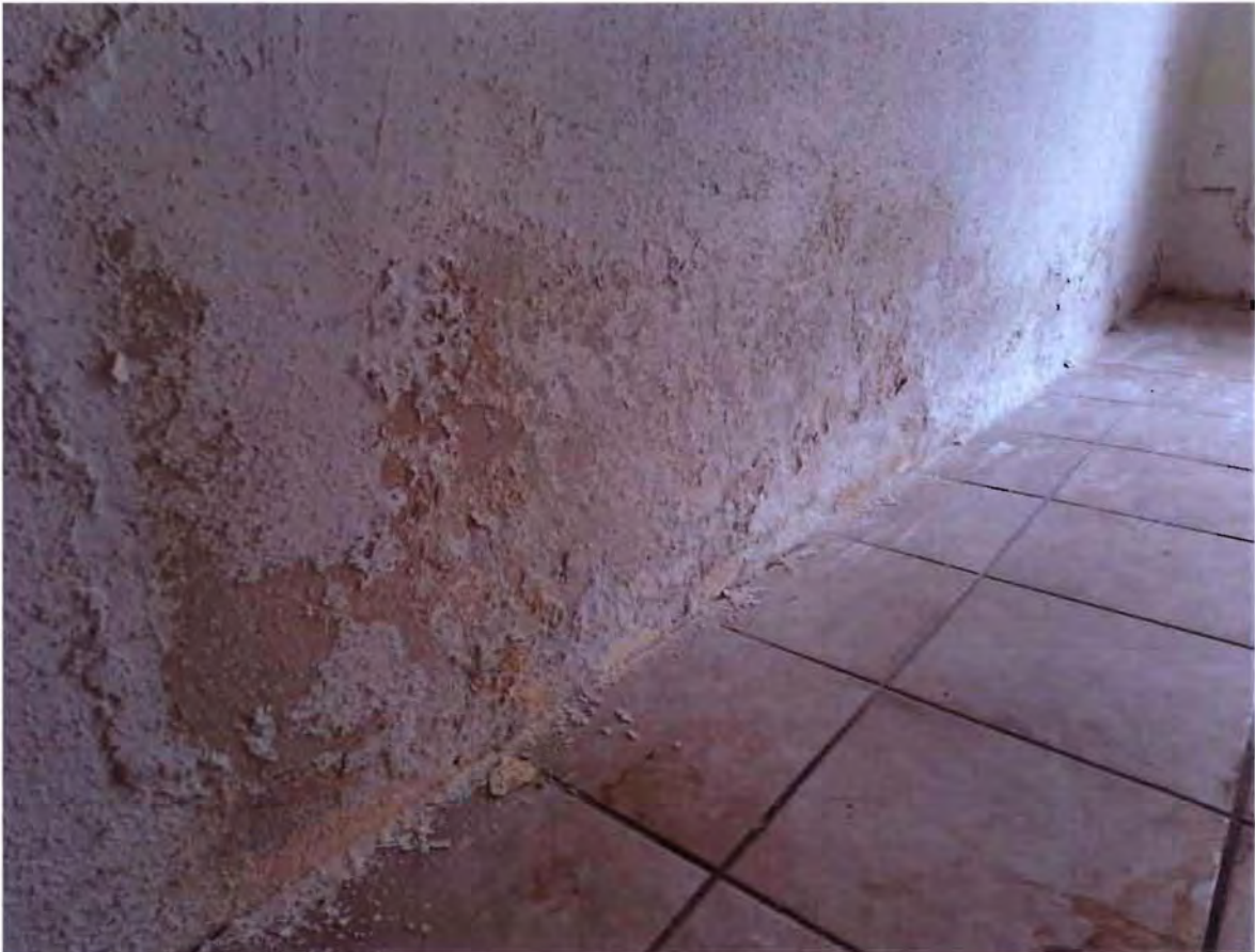
35 Ausblühungen Innenwand, Gewerbeeinheit Nr. 2
