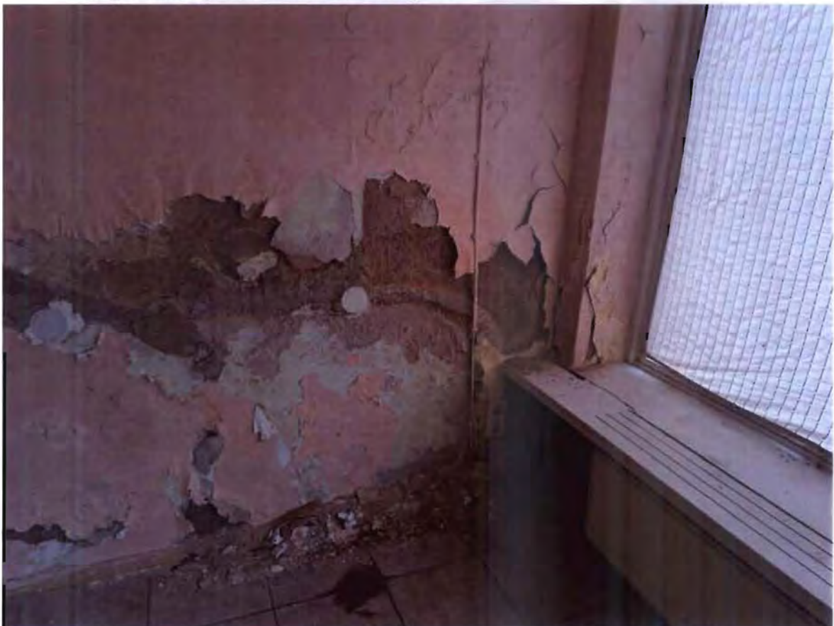
34 Schadensbild an der selben Außenecke, Gewerbeeinheit Nr. 2
