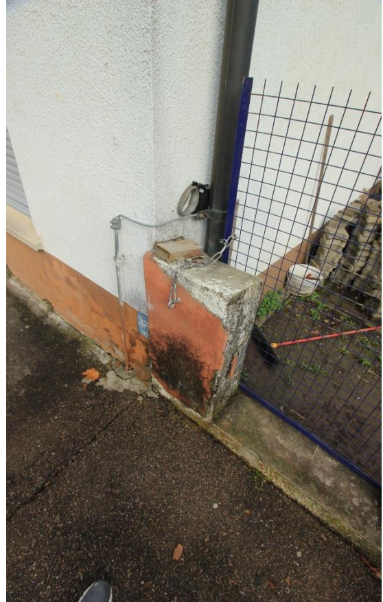
Pfeiler am Wohnhaus mit Schäden
