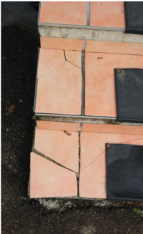
Fliesenschäden an der Eingangstreppe
