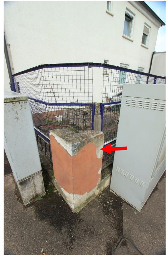
Pfeiler mit Schäden
