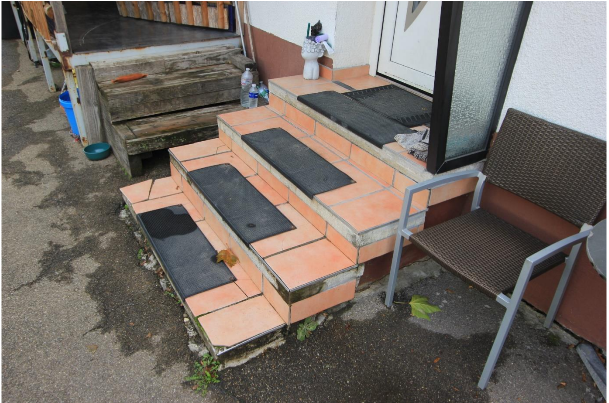
Treppenaufgang zum Hauseingang mit Schäden (Treppe baut auf Flst. 1033/101 über)
