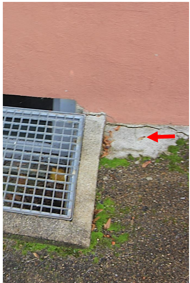
Sockelputzschäden beim Lichtschacht
