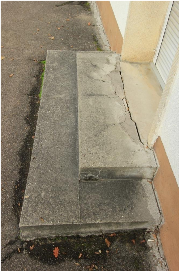
Treppe im Süden mit Rissen
