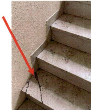
beispielhafte Ansicht einer abgebrochenen und reparierten Trittstufe im Bereich der Geschosstreppe im Kellergeschoss
