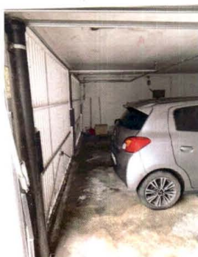
beispielhafte Ansicht der Verfärbungen im Deckenbereich
