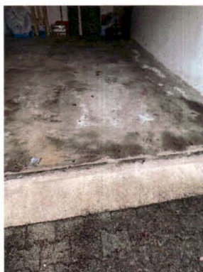
beispielhafte Ansicht der Ausblühungen am Betonboden
