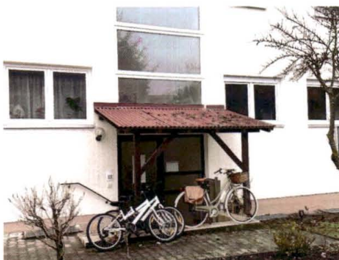
beispielhafte Ansicht der Moosablagerungen im Bereich der Eingangsüberdachung
