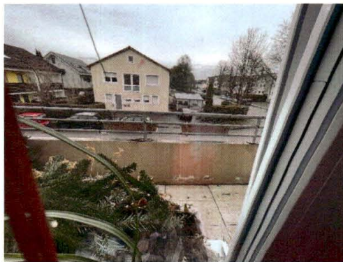
beispielhafte Ansicht der Farb- und Putzabplatzungen im Sockelbereich des Balkons im Obergeschoss
