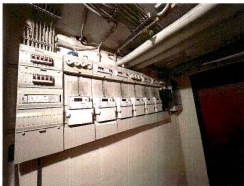
teilweise veraltete Knopfsicherungen im Flur des Kellergeschosses
