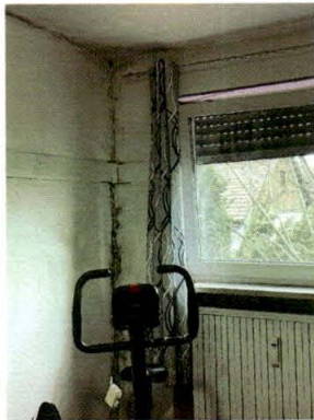
beispielhafte Ansicht des Schimmelbefalles im Wand- und Deckenbereich des Kinderzimmers
