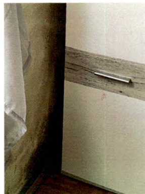
beispielhafte Ansicht des Schimmelbefalls an der Außenwand und im Deckenbereich des Wohnzimmers (Außenwand)
