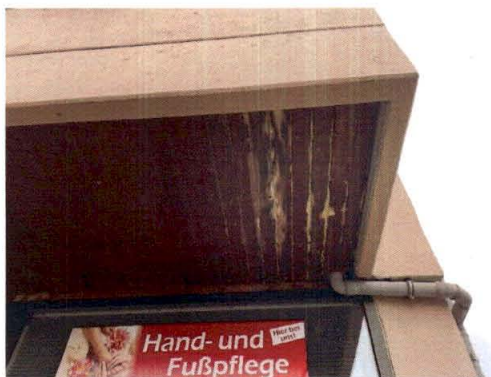
beispielhafte Ansicht der Farbablätterungen und Feuchtigkeitseinwirkungen an der Balkonuntersicht
