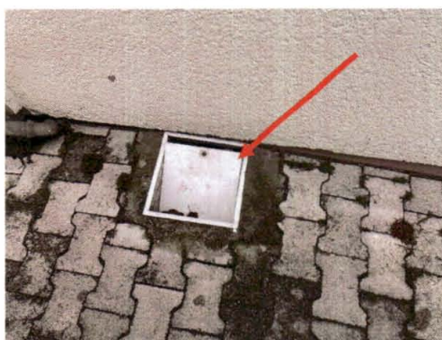
beispielhafte Ansicht der defekten Abdeckung im Zugangsbereich der Gebäude-Ostseite
