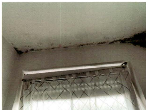
beispielhafte Ansicht des Schimmelbefalles im Deckenbereich, nahe der Außenmauer des Bades
