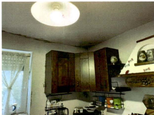
beispielhafte Ansicht des Schimmelbefalles im Bereich der Küche
