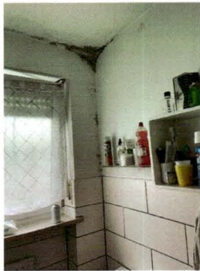
beispielhafte Ansicht des Schimmelbefalles in der Raumecke und im Deckenbereich der Außenmauer des Gäste-WC's
