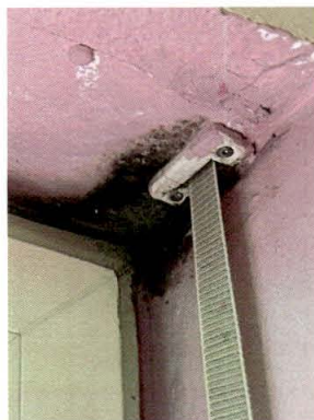
beispielhafte Ansicht des Schimmelbefalles im Bereich der Abdeckung des Rollladenkastens im Schlafzimmer
