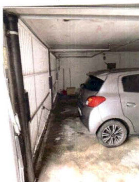
beispielhafte Ansicht der Verfärbungen im Deckenbereich
