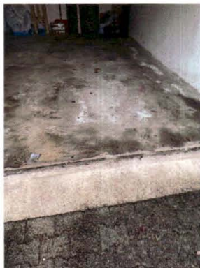
beispielhafte Ansicht der Ausblühungen am Betonboden
