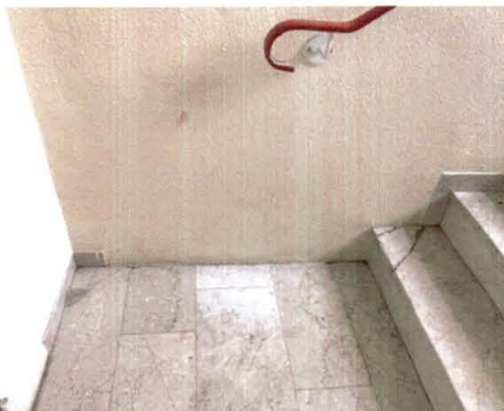
beispielhafte Ansicht der fehlenden Sockelfliesen am Treppenvorplatz des Kellergeschosses
