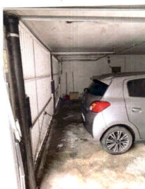
beispielhafte Ansicht der Verfärbungen im Deckenbereich
