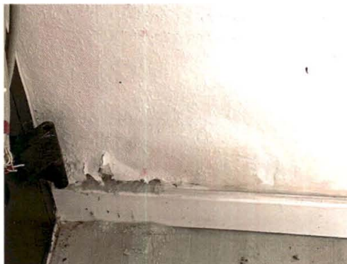
beispielhafte Ansicht der eindringenden Feuchtigkeit mit den nebenstehend dargestellten Folgeerscheinungen
