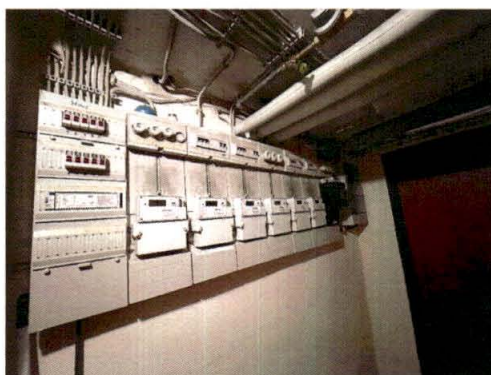
teilweise veraltete Knopfsicherungen im Flur des Kellergeschosses
