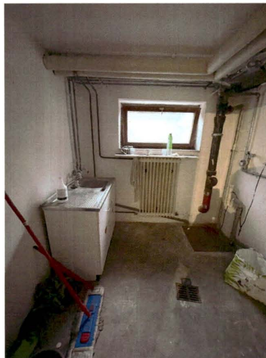
beispielhafte Ansicht der Waschküche im Kellergeschoss
