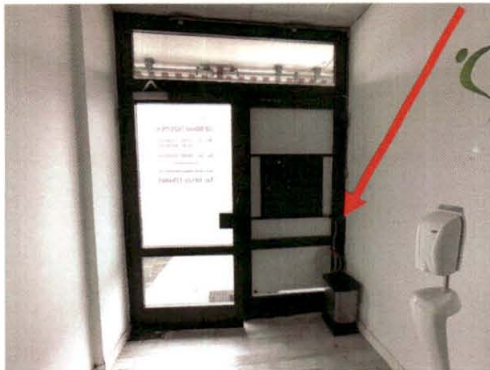
beispielhafte Ansicht der wenig fachmännisch verlegten Kabel im Bereich des Eingangselements
