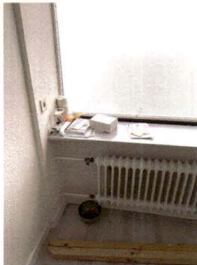
beispielhafte Ansicht des undichten Heizkörpers im Bereich der Gewerbeeinheit Nr. 1
