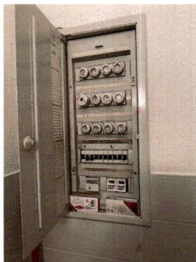
beispielhafte Ansicht des Sicherungskastens in- nerhalb der Gewerbeeinheit Nr. 1
