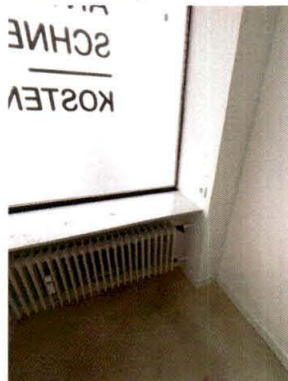
beispielhafte Ansicht eines Radiators im „Testraum 1“ der Gewerbeeinheit Nr. 1
