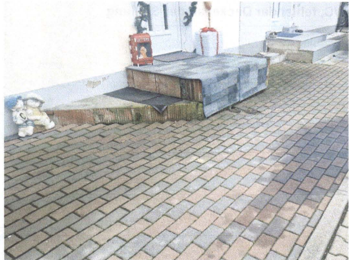
Eingangstreppe, dunkle Verschmutzungen auf dem Pflaster
