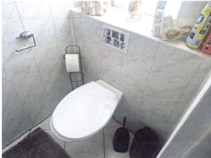
Gäste-WC, fehlender Deckel an der Spülung
