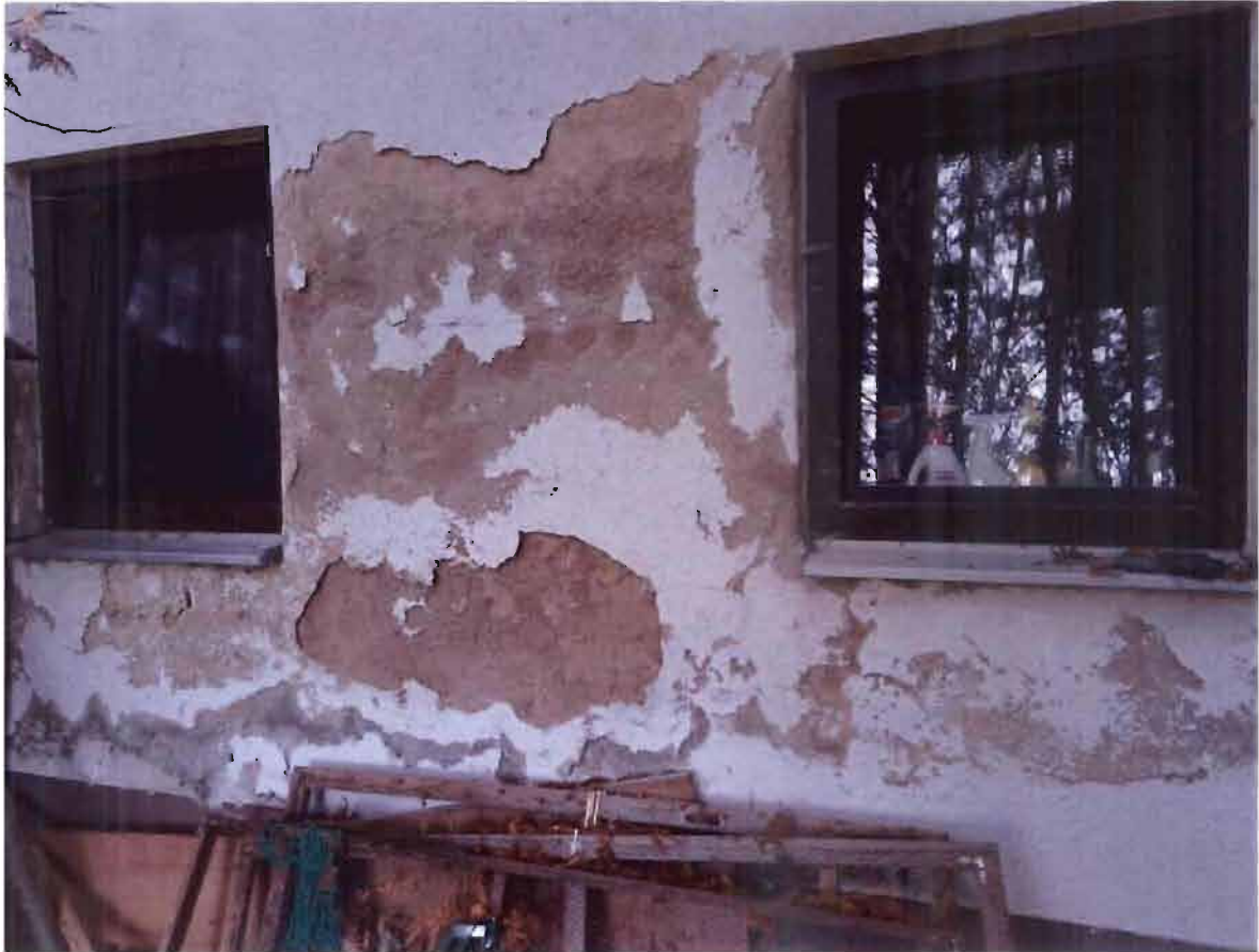
33 großflächiger Schaden am Außenputz beim Hauswirtschaftsraum
