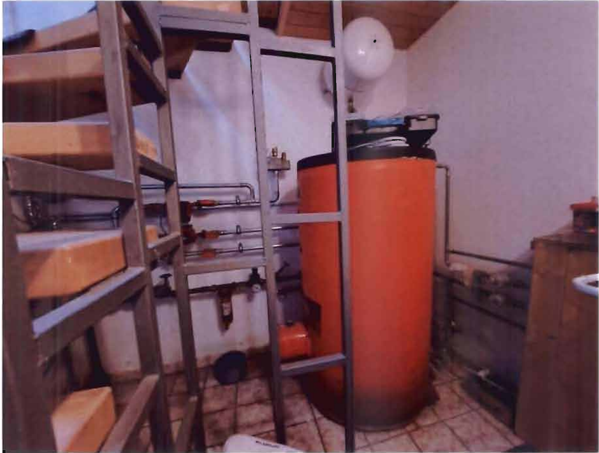
17 Warmwasserübergabestation (Fernwärme) und Warmwasserspeicher 300 Liter
