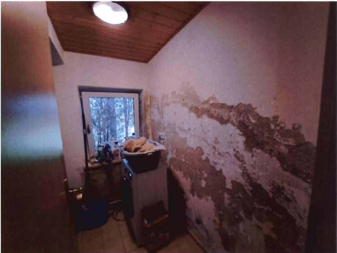
20 Wohnung Nr. 1 EG, Hauswirtschaftsraum mit Feuchtigkeitsschaden
