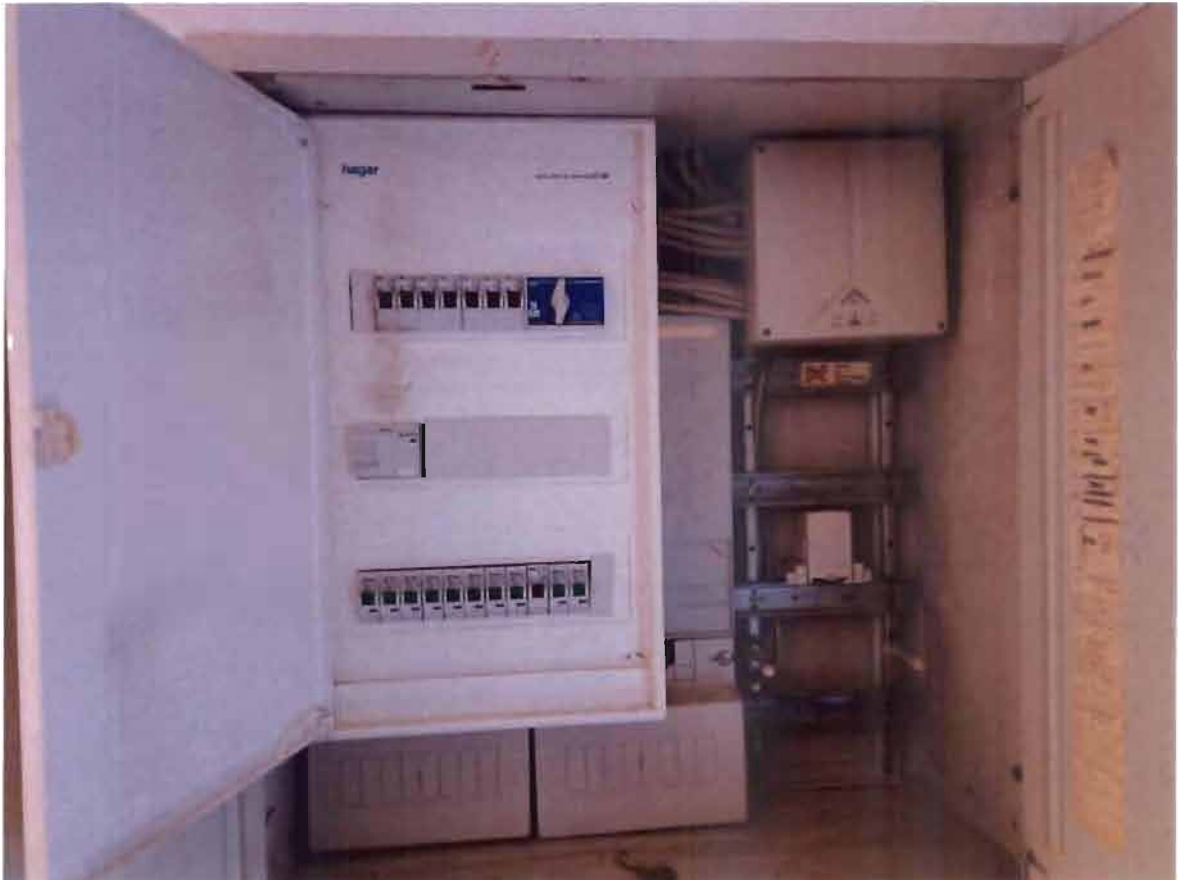
18 Wohnung Nr. 1 EG, Unterverteilung mit FI-Schutzschalter
