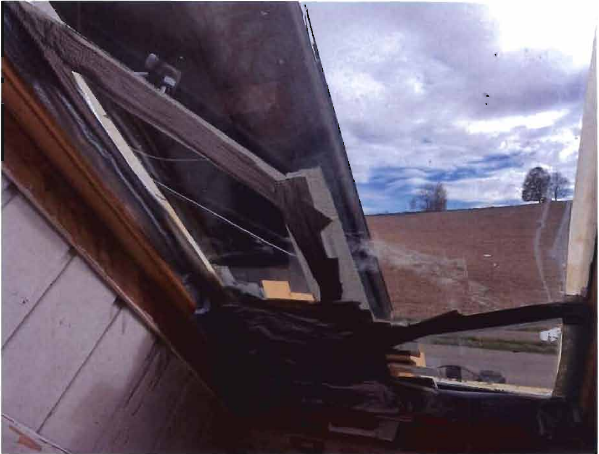
31 Wohnung Nr. 2 DG, defektes Dachflächenfenster
