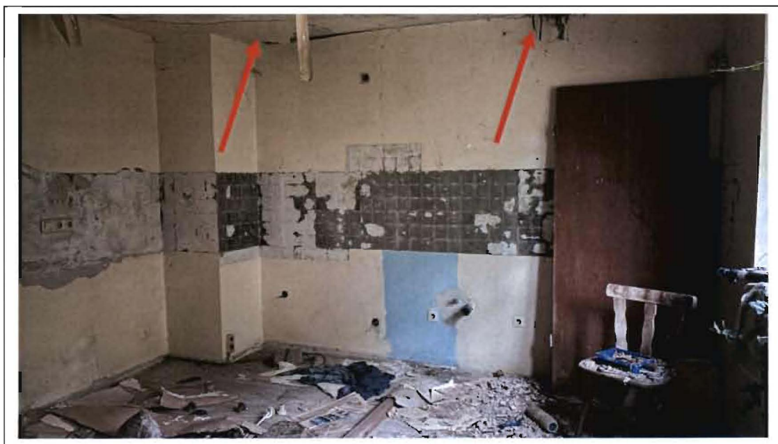
Foto 13: Blick in die Küche; defekte Decke
