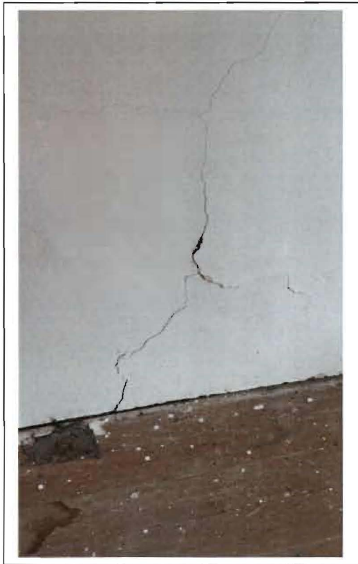
Foto 22: Risse an der Wand
