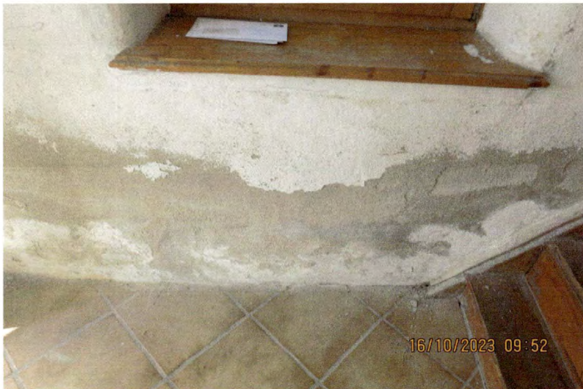
Bild 2 – Nässeschäden im Flur
