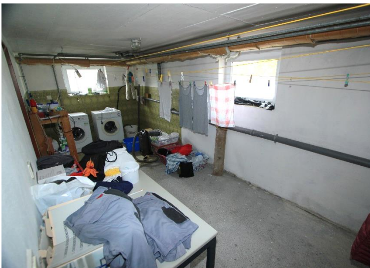
Waschküche mit fehlendem Estrich
