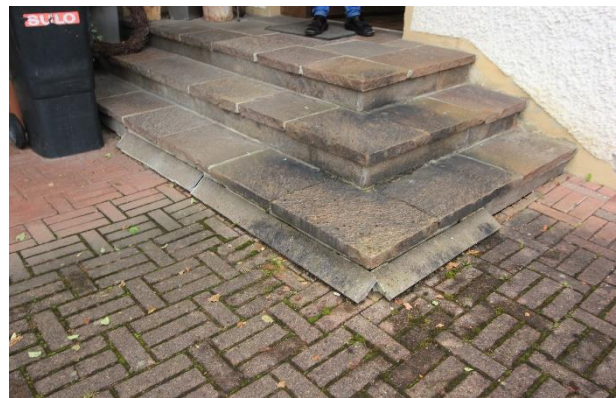
Lose Platten an der Eingangstreppe
