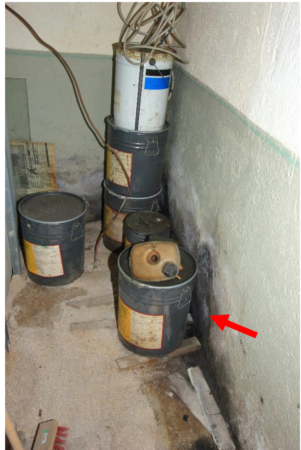
Feuchtflecken an den Wänden
