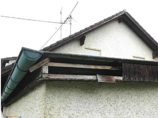
Schäden an der Dachumrandung
