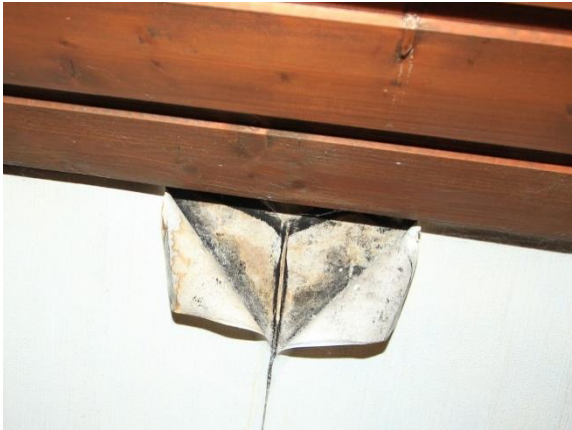
Feuchtflecken an der Decke
