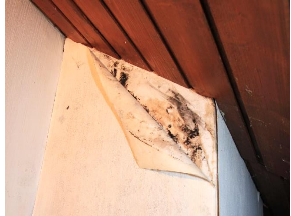
Feuchtflecken unter der Decke
