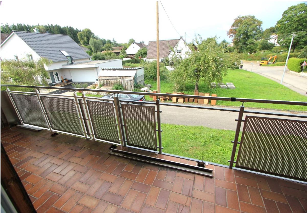
Giebelbalkon mit schadhaften Geländer, Blick nach Westen
