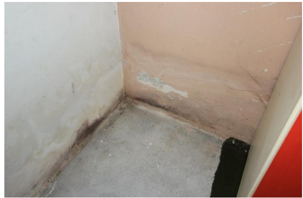
Feuchteflecken an den Wänden im UG
