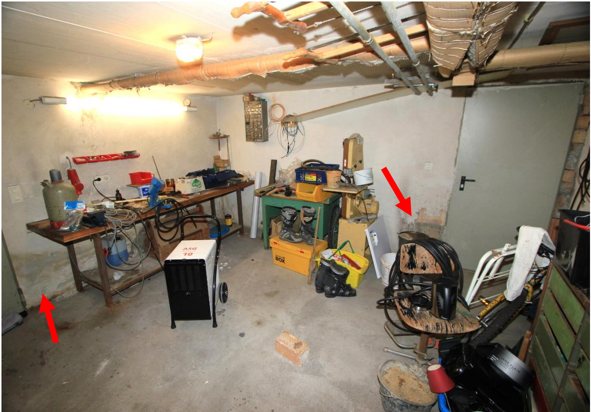
Keller, links Tür zur Garagentreppe, rechts Tür zum Öllager, Pfeile Feuchtflecken an Wänden
