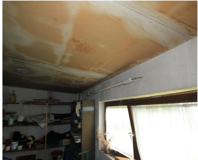
Undichtes Garagendach mit Feuchtflecken
