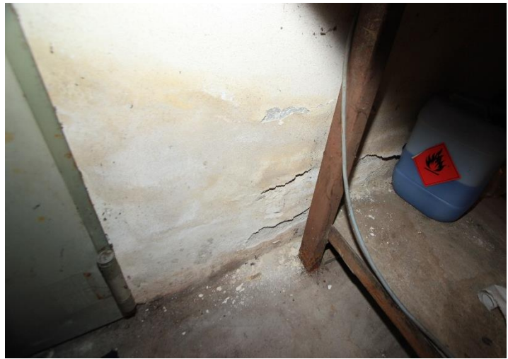
Wandschäden mit Putzabplatzungen
