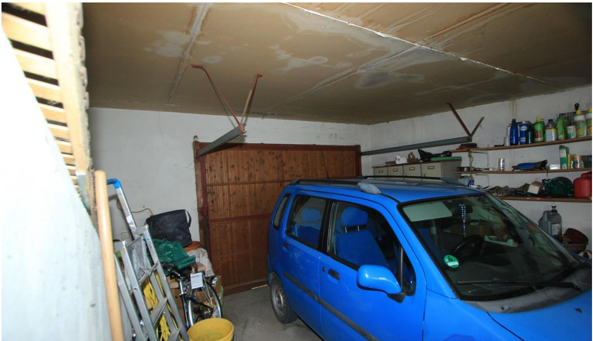
Garage von innen mit Feuchtflecken an der Decke
