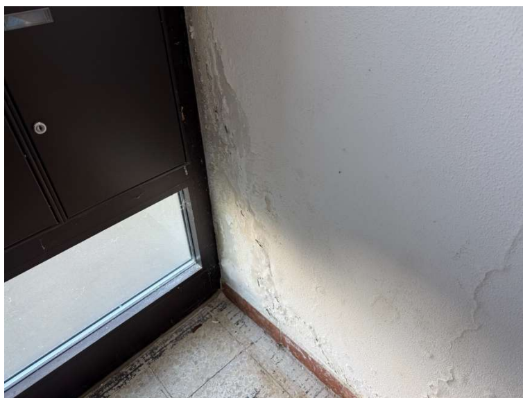
Aufsteigende Feuchtigkeit am Haustürelement innen
