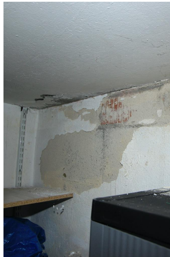
Alter Wasserschaden an Wand und Decke
