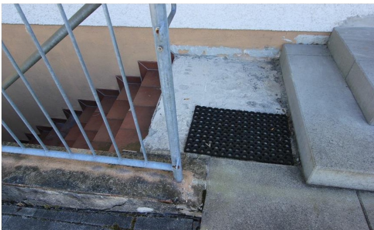
Fehlender Belag bei der Kelleraußentreppe
