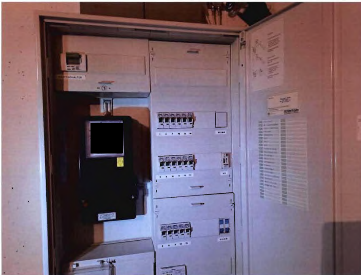
14 UG, Hauptverteilung, Sicherungskasten
