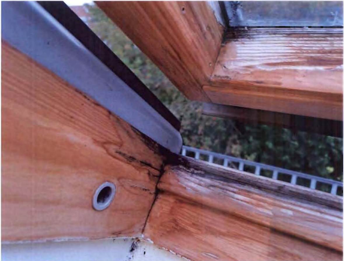
23 DG, defektes Dachflächenfenster im Speicher
