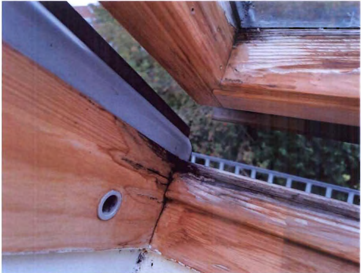
23 DG, defektes Dachflächenfenster im Speicher
