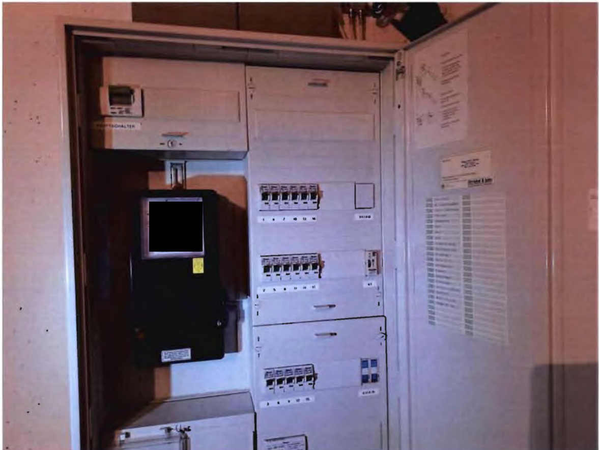
14 UG, Hauptverteilung, Sicherungskasten
