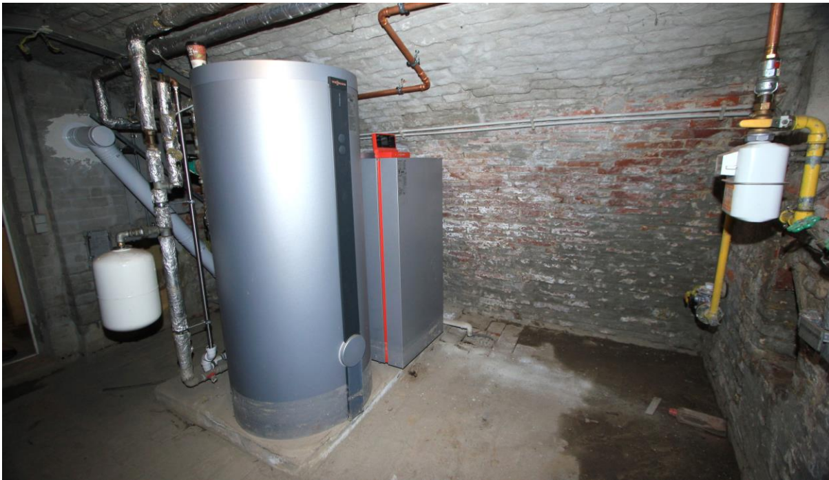
Heizungsraum im Gewölbekeller UG West
