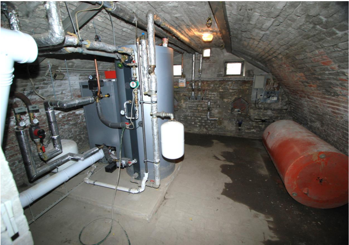
Gewölbekeller mit Heizung
