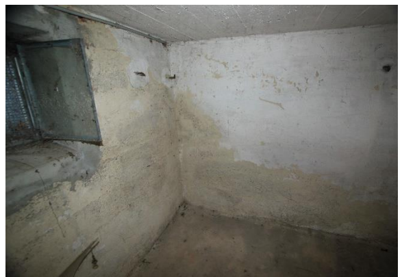
Feuchtflecken an den Wänden
