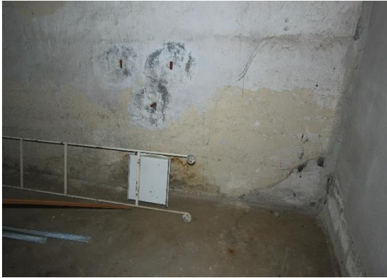
Kellerraum mit Wandschäden
