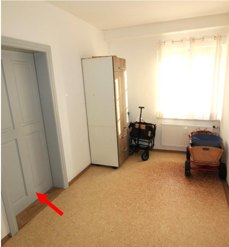
Treppenhausflur OG West, Pfeil Zimmertür Wohnung 6
