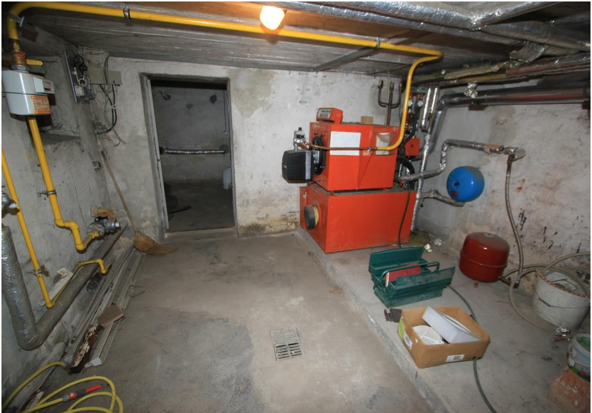
Heizungsraum mit Feuchteflecken
