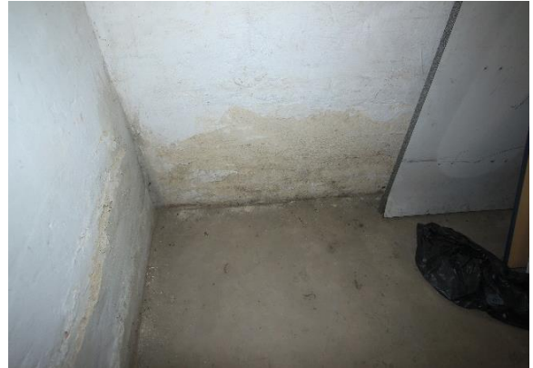
Feuchtflecken an der Wand
