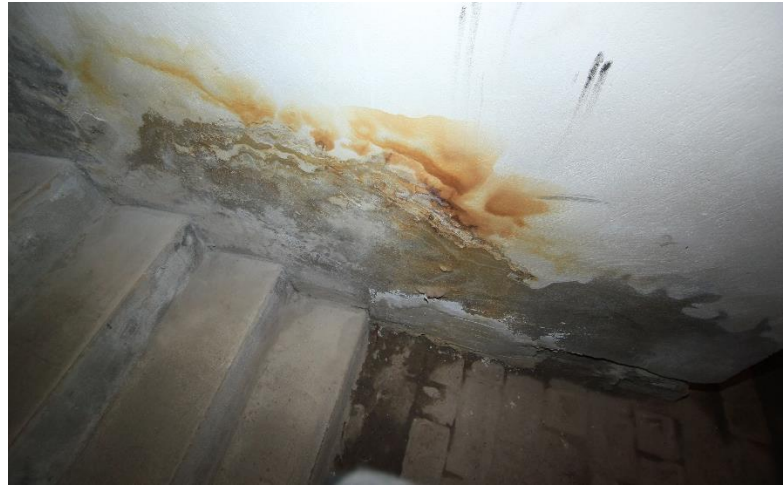
Feuchteflecken an den UG-Wänden
